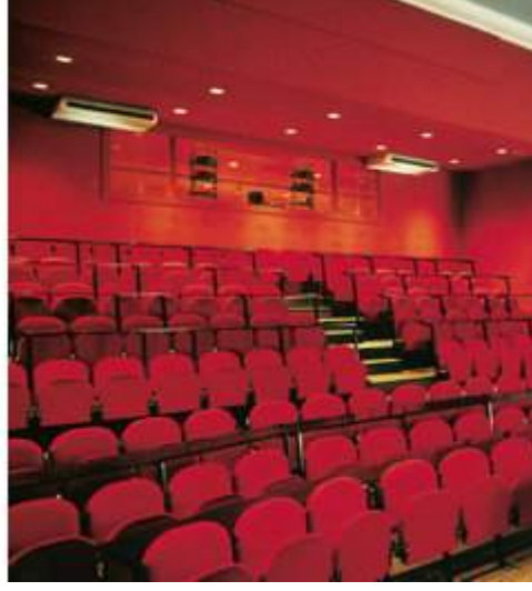
Şekil 25 Anfi'de duvar tipi Split HVAC üniteleri
