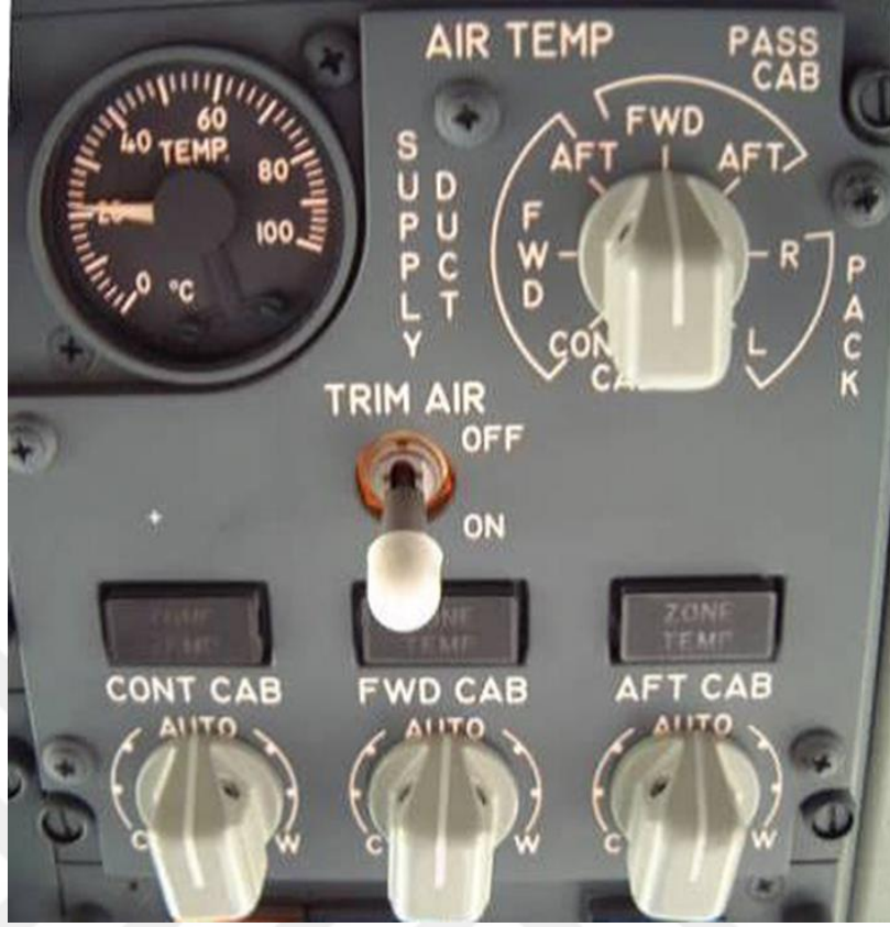
Şekil 4.33. B 737 nin kokpitinde bulunan Air conditioning (kabin içi havalandırma) gösterge paneli
