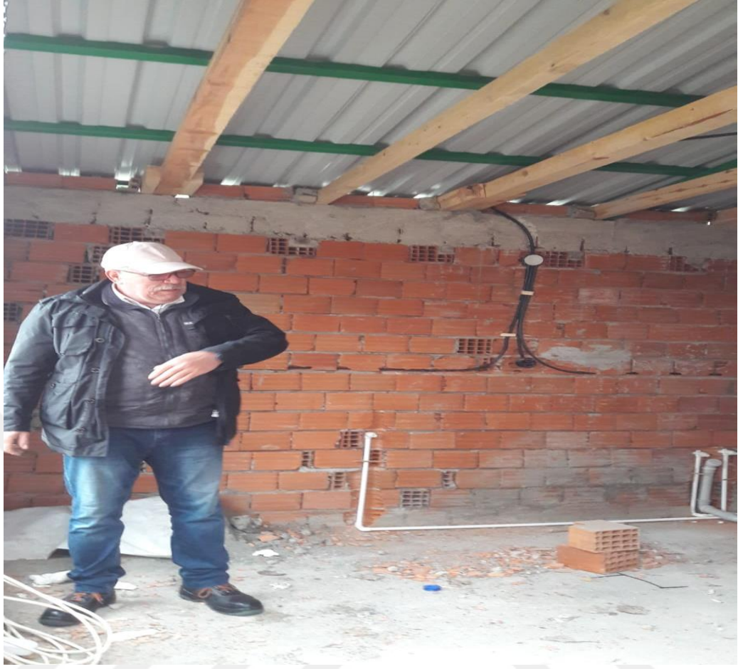
Mecidiye Köyü Camii ile Cemevi arasında yapılan aş evi inşaatı ve köy muhtarı Fahrettin Korkutan
