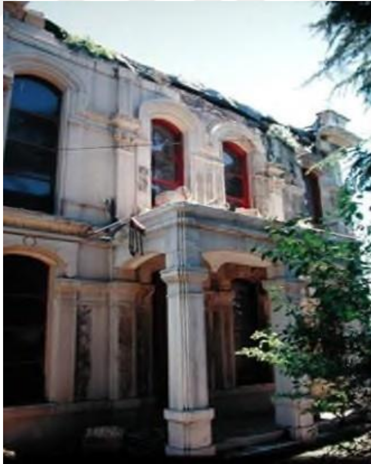
Resim 70: İzmit Kasrının dökülen çatı parapetleri. (Kâhya, 2012:139).
