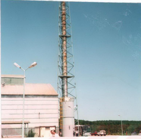
Resim 4.5. İstanbul Rumeli Yakası hastahane atıkları yakma tesisi
