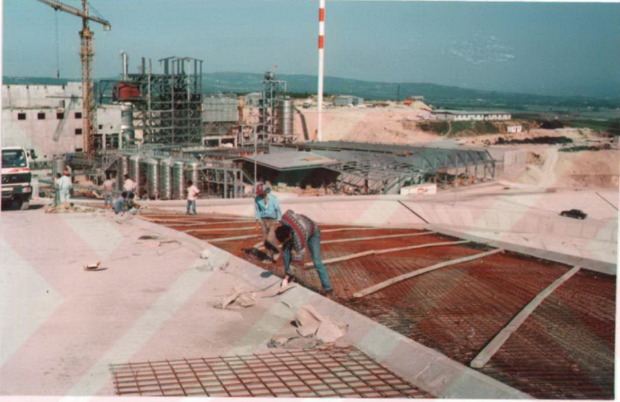
Resim 5.5. İzmit Büyükşehir Belediyesi Klinik Atıkları Yakma Tesisi
