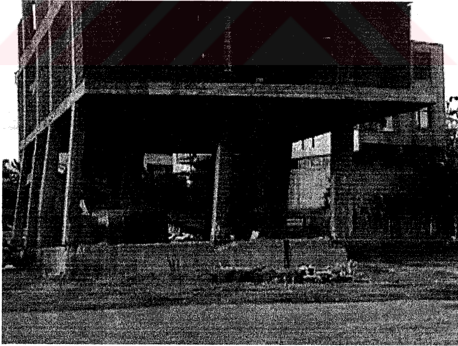
Şekil 2.9. 1999 Adapazarı depreminde yumuşak kat hasarı görmüş bina
