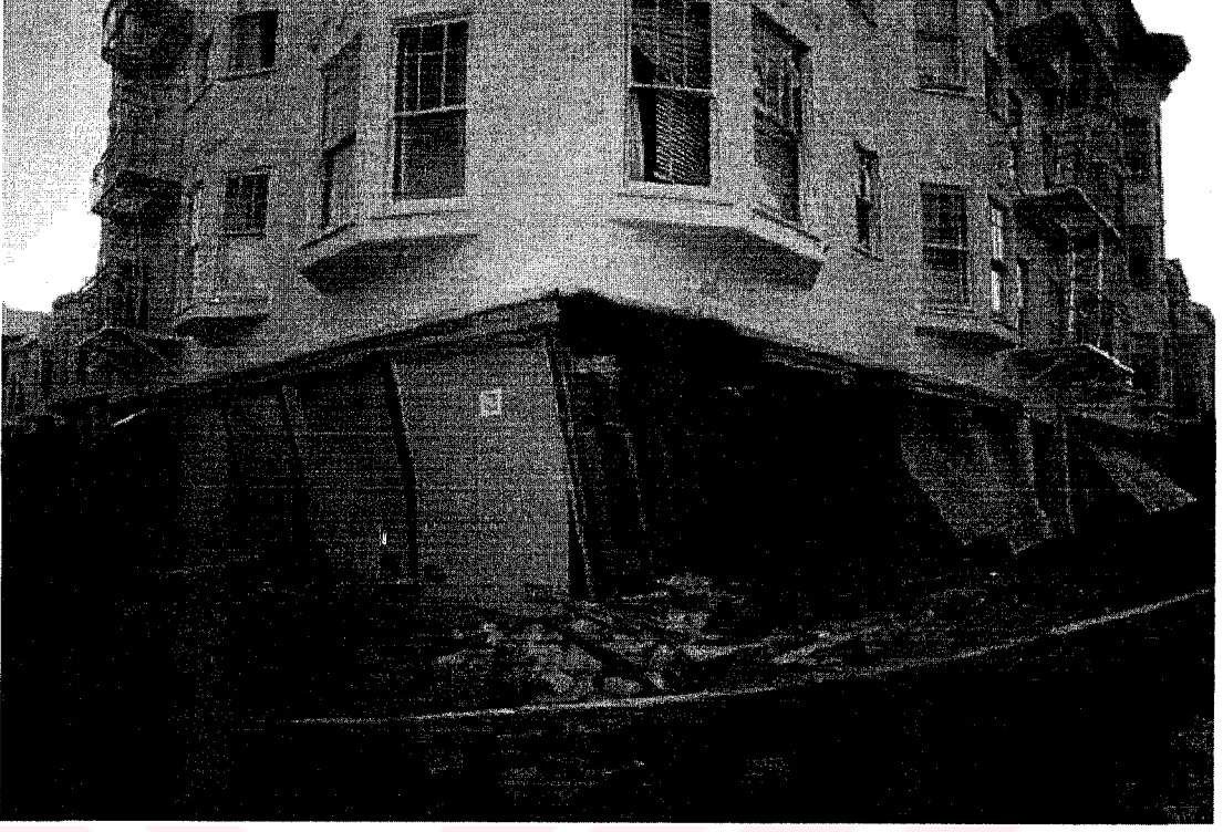
Şekil 2.8. San Francisco'da yumuşak kat hasarı görmüş bir bina
