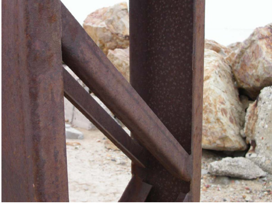
Şekil 3.18: Kaynaklı bölgelerde korozyon görülmemiş elektrik direkleri (NN 2007).
