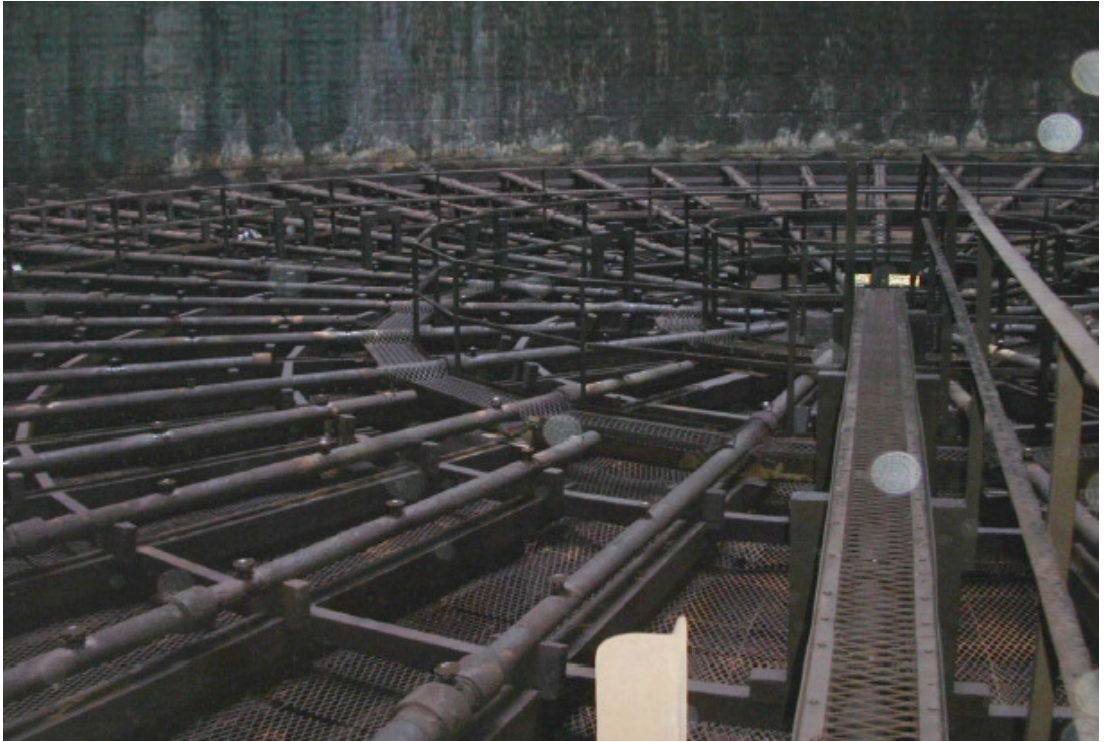
Şekil 3.17: 20 yıldır kullanımda olan soğutma kulesinin içindeki X- Grid elemanlarının görünüşü, çap yaklaşık olarak 52 m (NN 2007).
