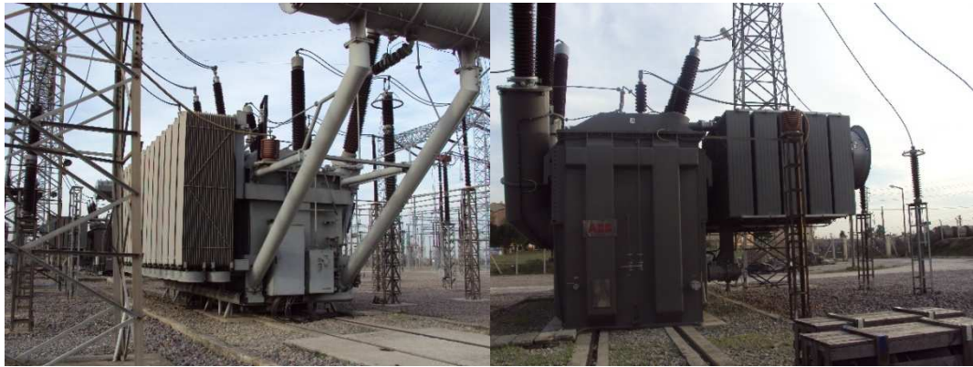
Şekil 1.1: Tepeören İndirici Trafo Merkezi
