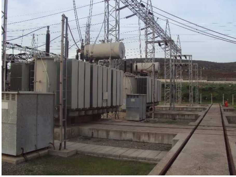
Şekil 1.2: İçmeler İndirici Trafo Merkezi
