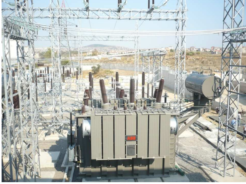
Şekil 1.3: Tuzla İndirici Trafo Merkezi
