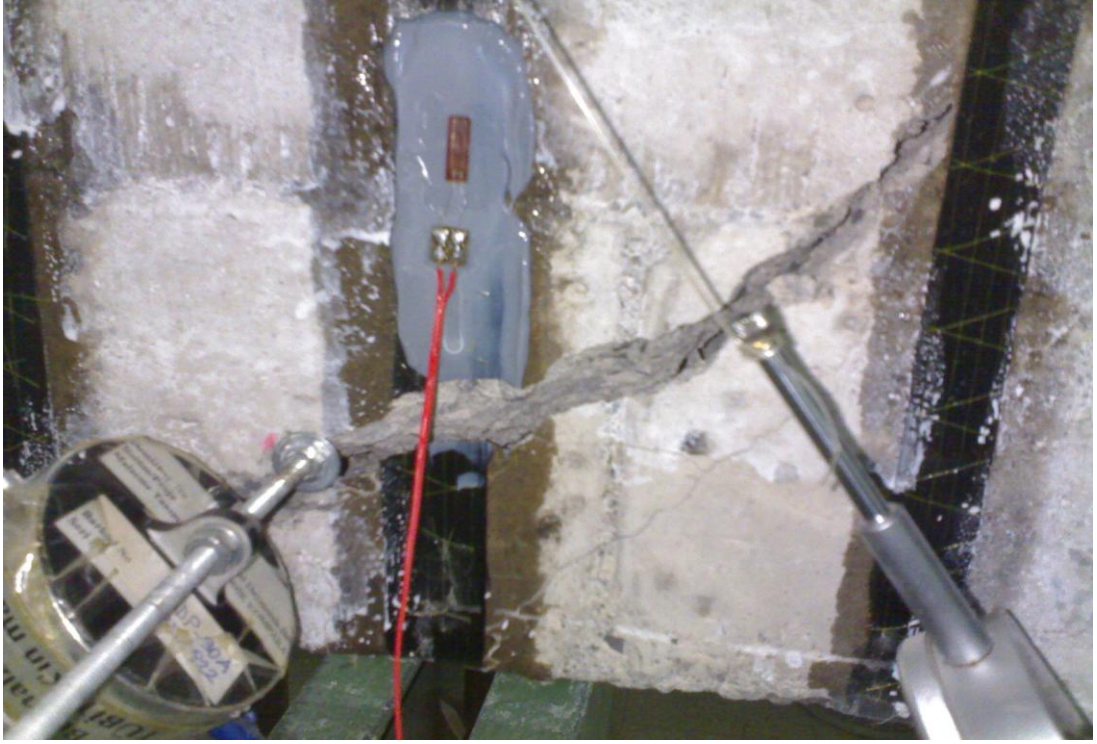
Şekil 5.7: BHU numunesinde Hi-CFRP elyafın kopması
