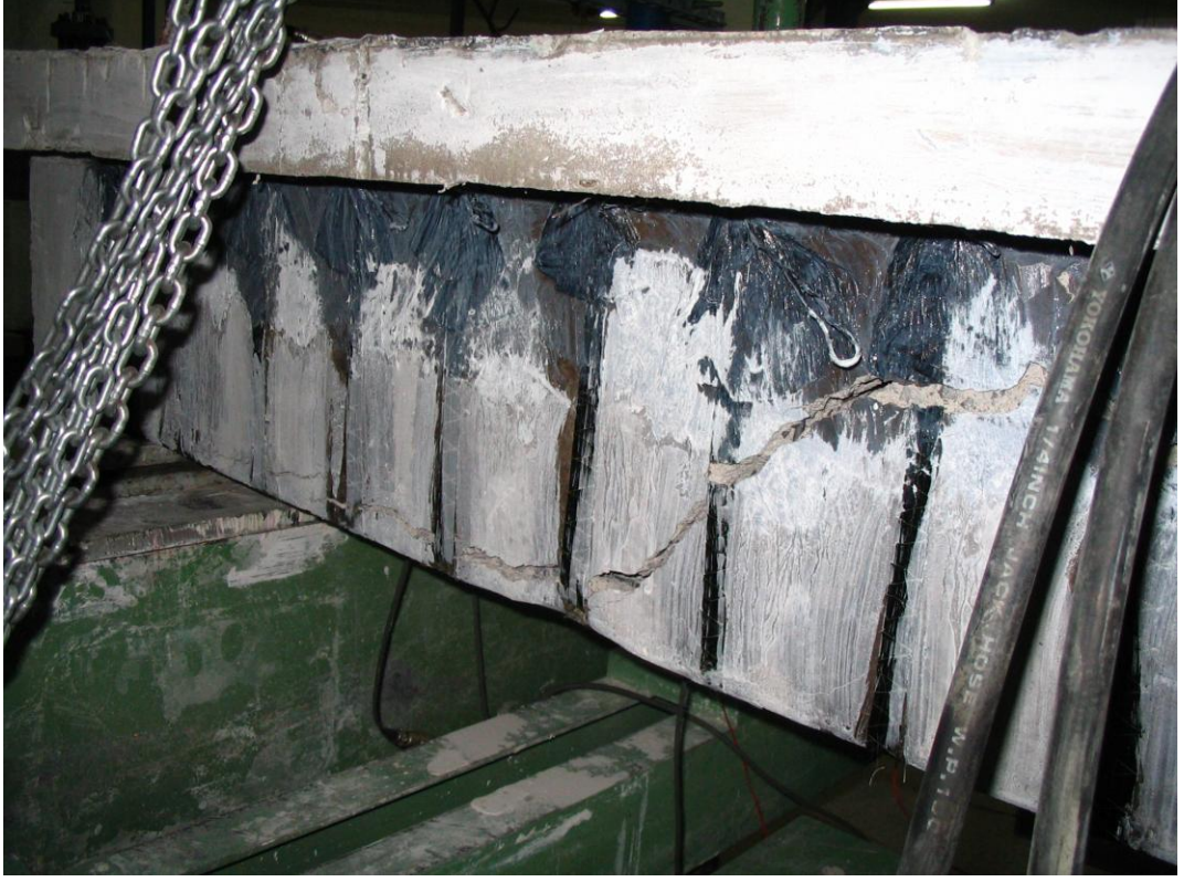
Şekil 4.14: BHA numunesinde göçmenin oluştuğu ana çatlağın resmi
