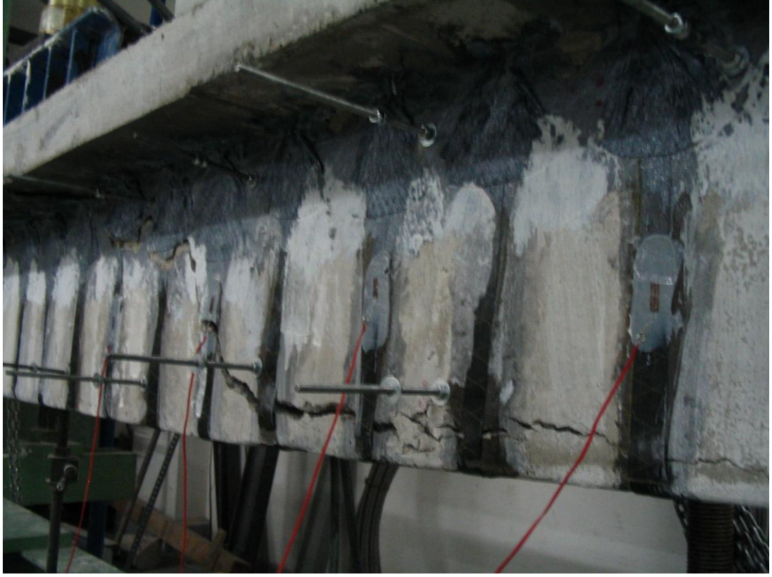
Şekil 5.11: BHA numunesinde ankraj çivilerinin kopması
