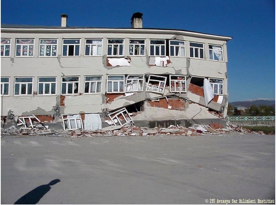
Şekil 3.4. Ağır hasar, 1999 Kocaeli depremi, İzmit (İTÜ Arşivi)
