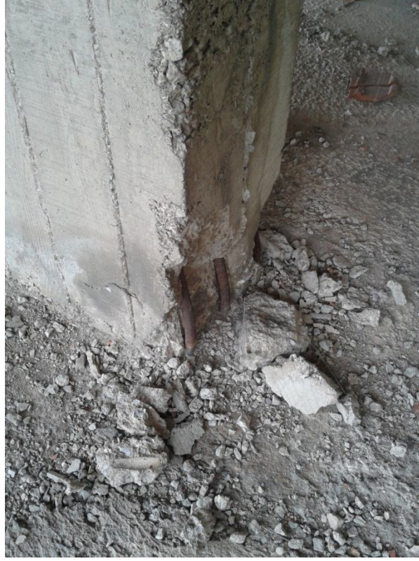
Şekil 8.3. Zemin kat kolonda mafsallaşma -1
