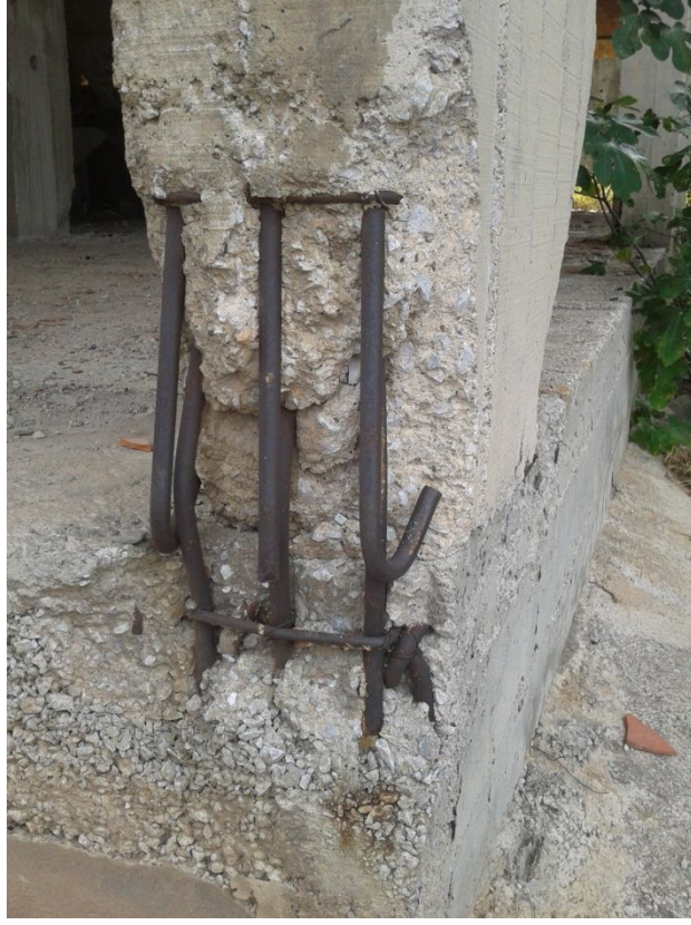
Şekil 8.5. Zemin kat kolonda mafsallaşma - 3
