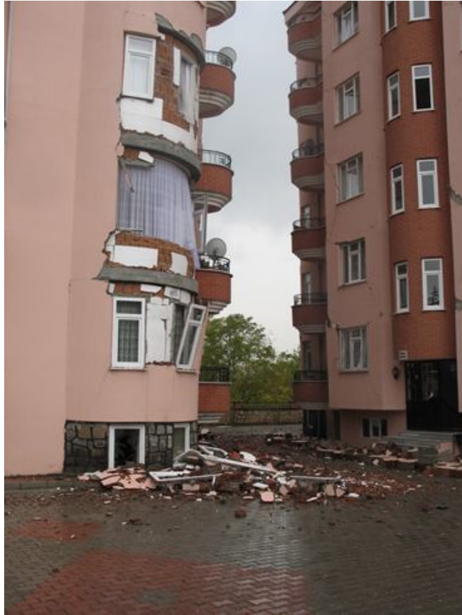
Şekil 3.3. Orta hasar, 1999 Kocaeli depremi, İzmit (Kocaeli Devlet Arşivi)
