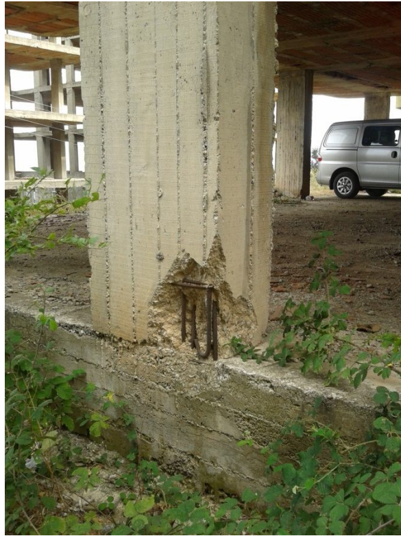
Şekil 8.4 Zemin kat kolonda mafsallaşma -2
