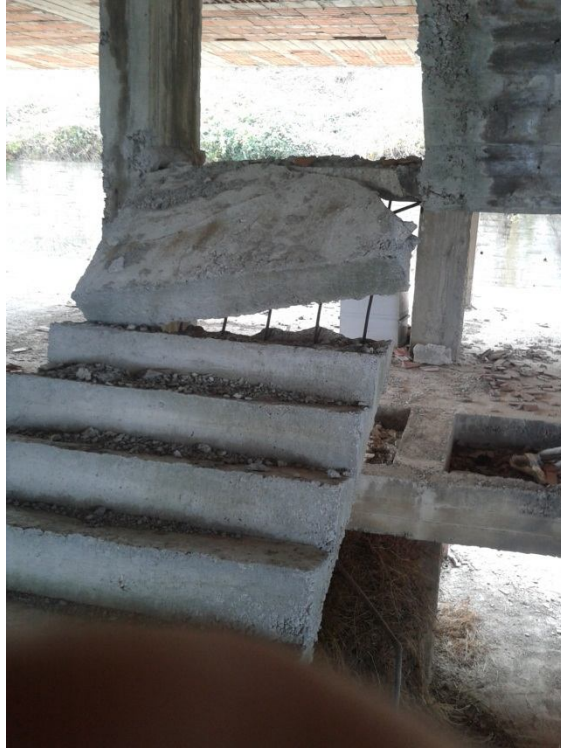
Şekil 8.6. Merdiven plak hasarı
