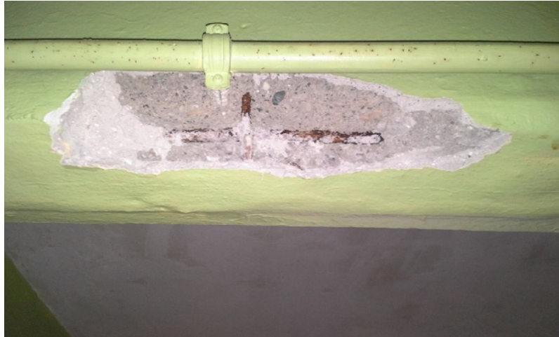
Şekil 3.7. Donatı korozyonu (Anka İnşaat Arşivi)
