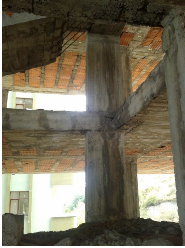
Şekil 8.7. Merdiven kovanında hasar
