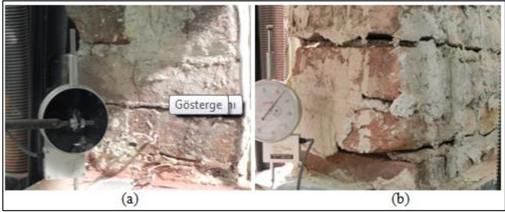
Şekil 3.37. Mas1 - Enj. numunesi basınç (a) ve çekme bölgesinde (b) oluşan çatlaklar
