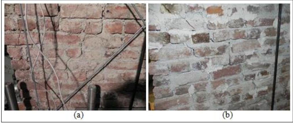
Şekil 3.32. Mas0 - Ref. numunesi basınç bölgesi (a) ve diyagonal bölgede (b) oluşan çatlaklar
