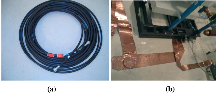
Şekil 2.15: Ölçüm kablosu ve Topraklama bağlantıları (a) Çift ekranlı koaksiyel ölçüm kablosu (b) Bakır topraklama bağlantısı
