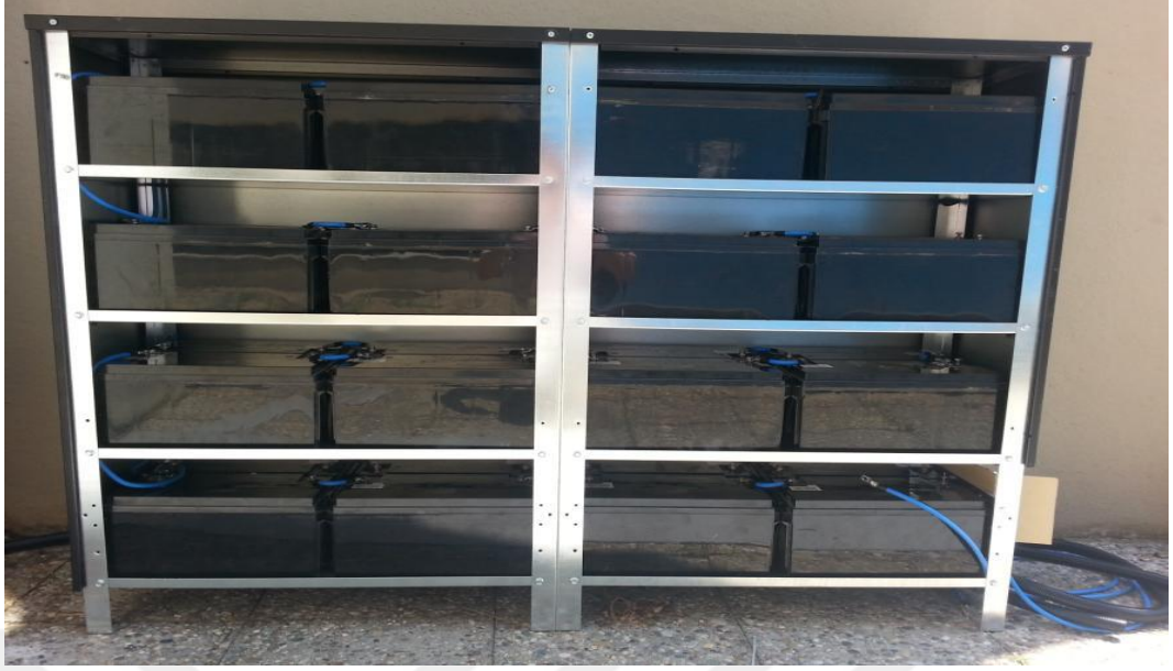
Şekil 4.10. Batarya grubu ve bağlantı fotoğrafı
