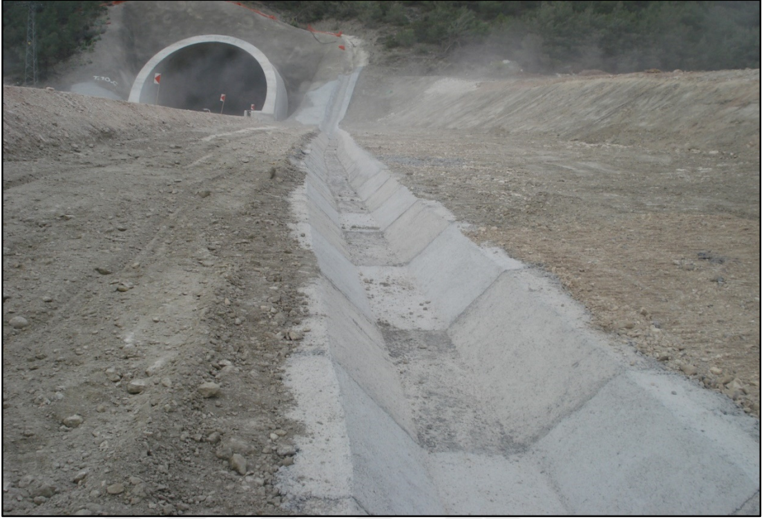
Şekil 4.9. Yüzey drenaj kanalları
