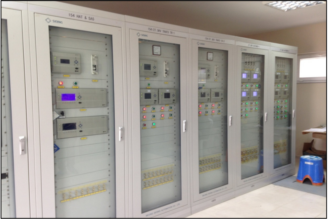
Şekil 2.101. Haberleşme sistemi teknik bina iç donanım
