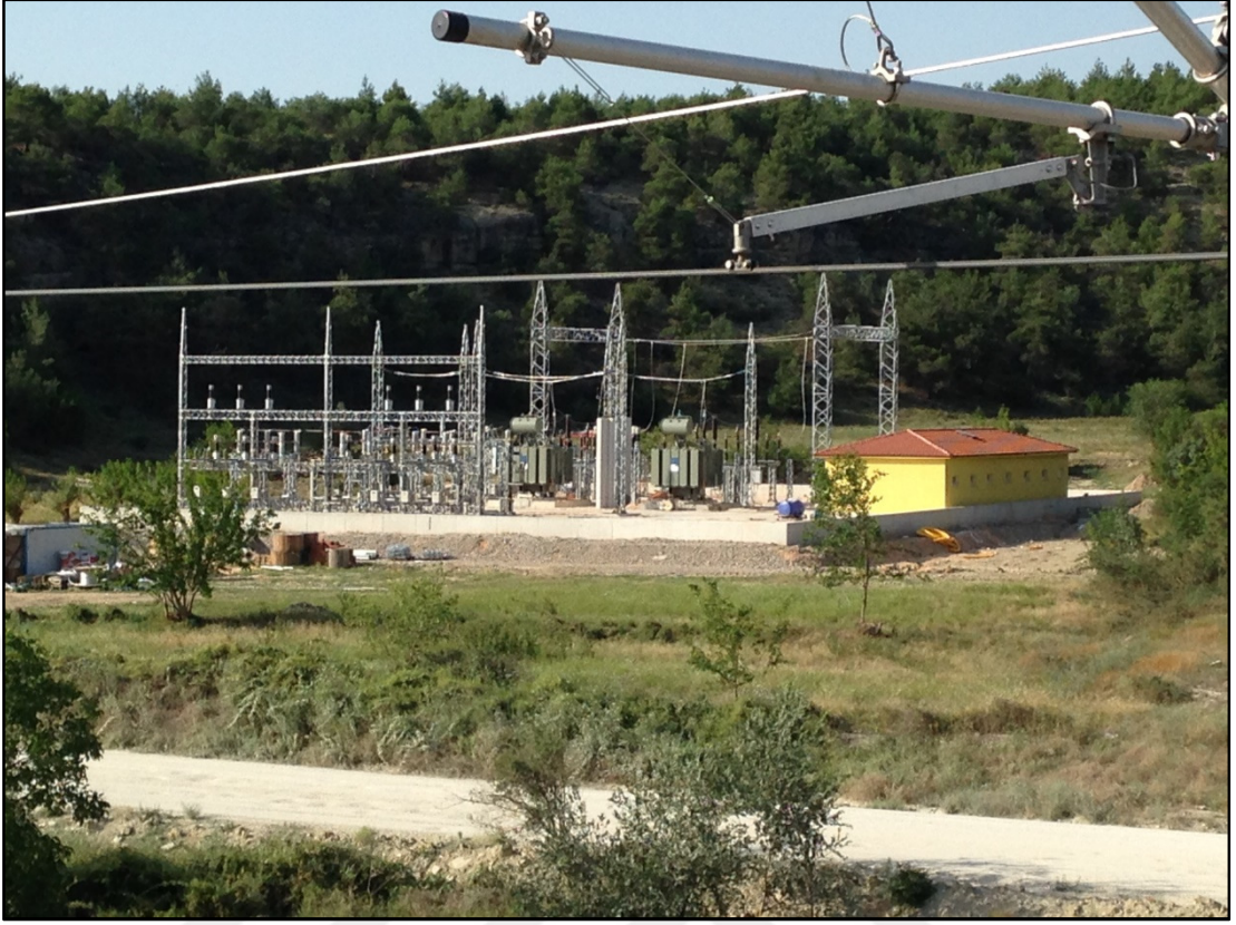
Şekil 2.100. Güç trafo tesisi
