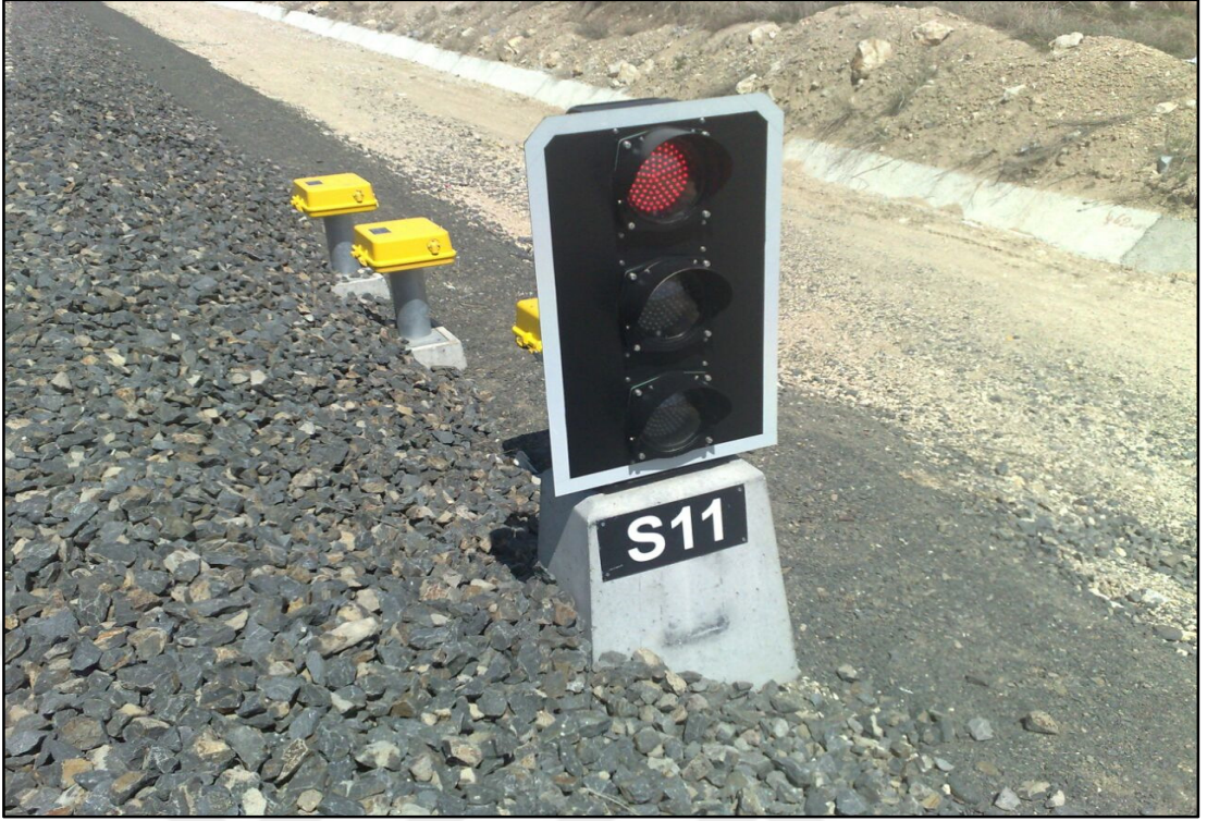
Şekil 2.96. İstasyon girişi cüce sinyal
