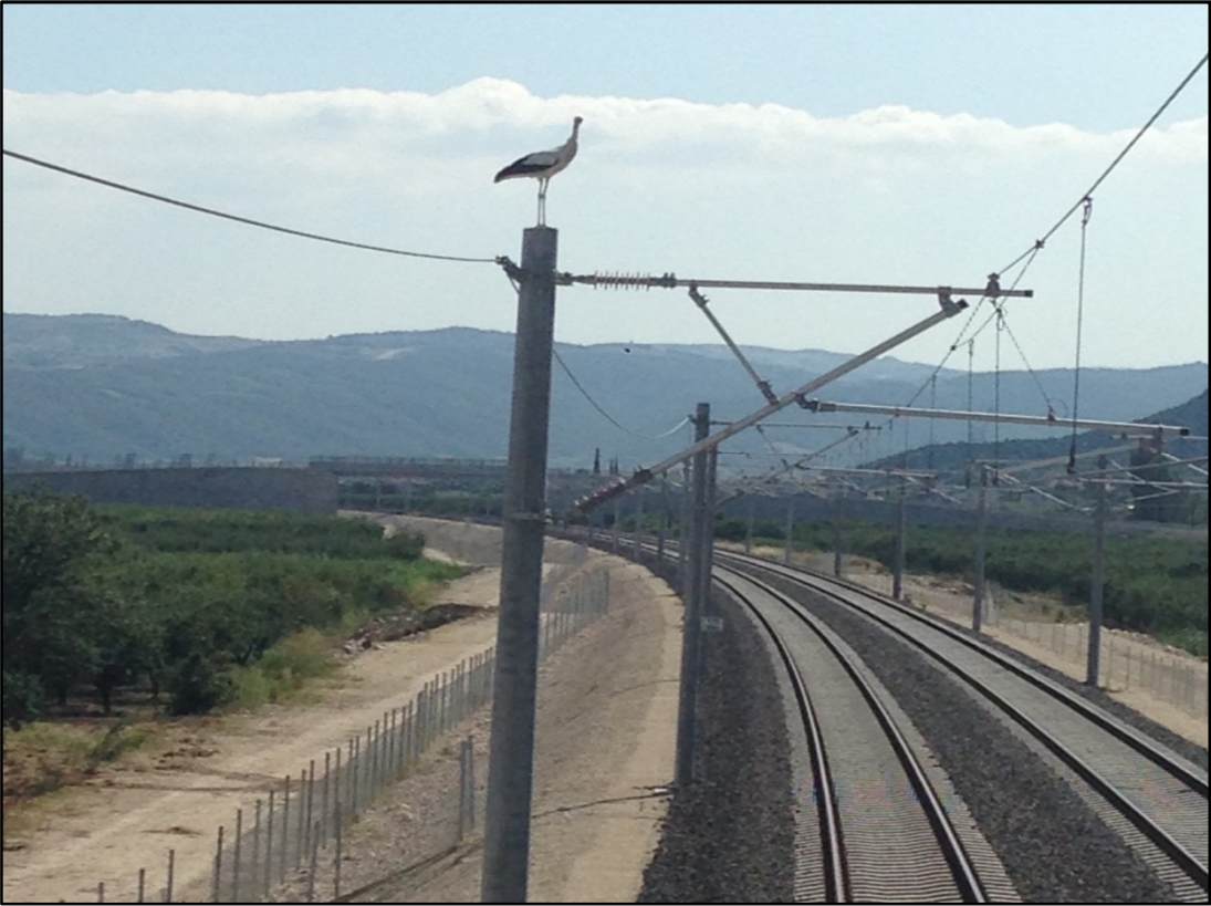
Şekil 2.91. Tamamlanmış elektrifikasyon sistemi
