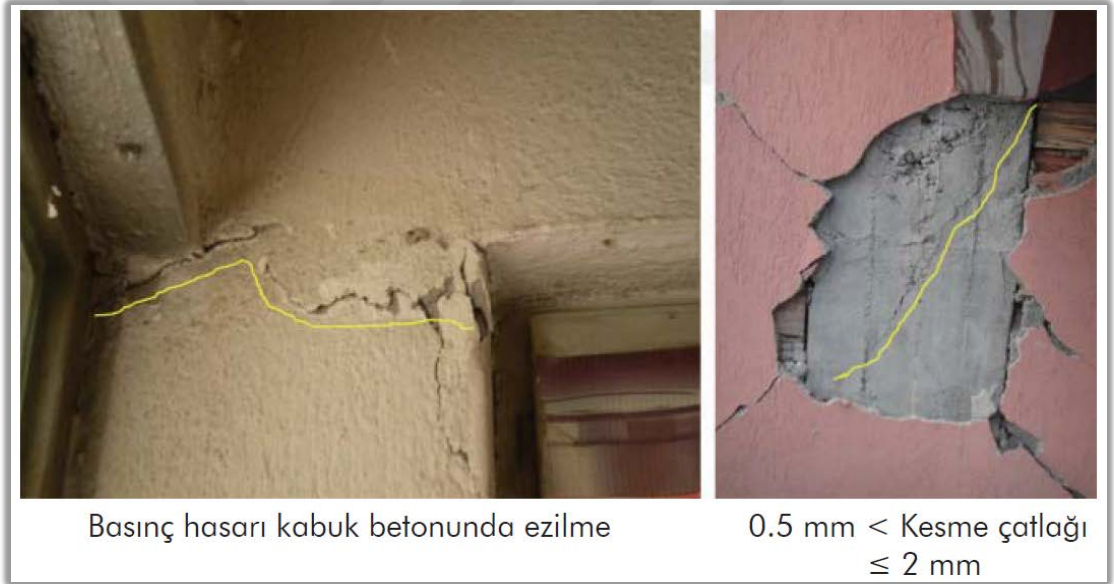
Şekil 4.7. Orta Hasar almış betonarme elemanlar (B Tipi) [10]
