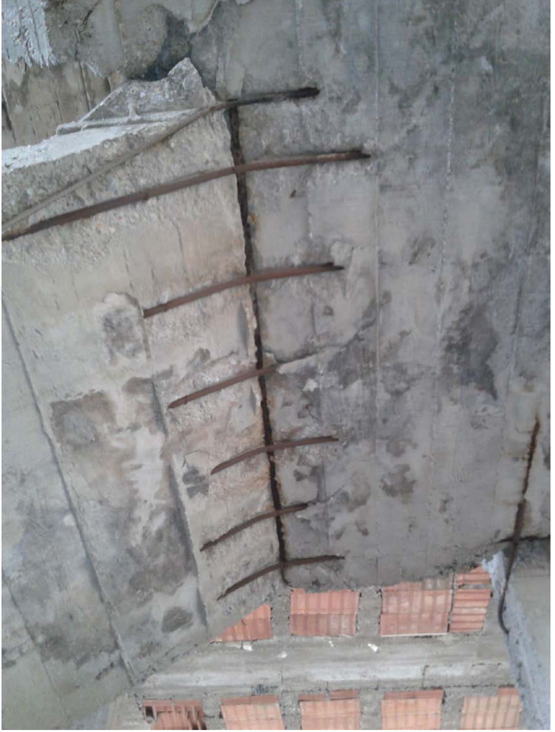
Şekil 6.15. Merdiven döşemesinde oluşan hasar
