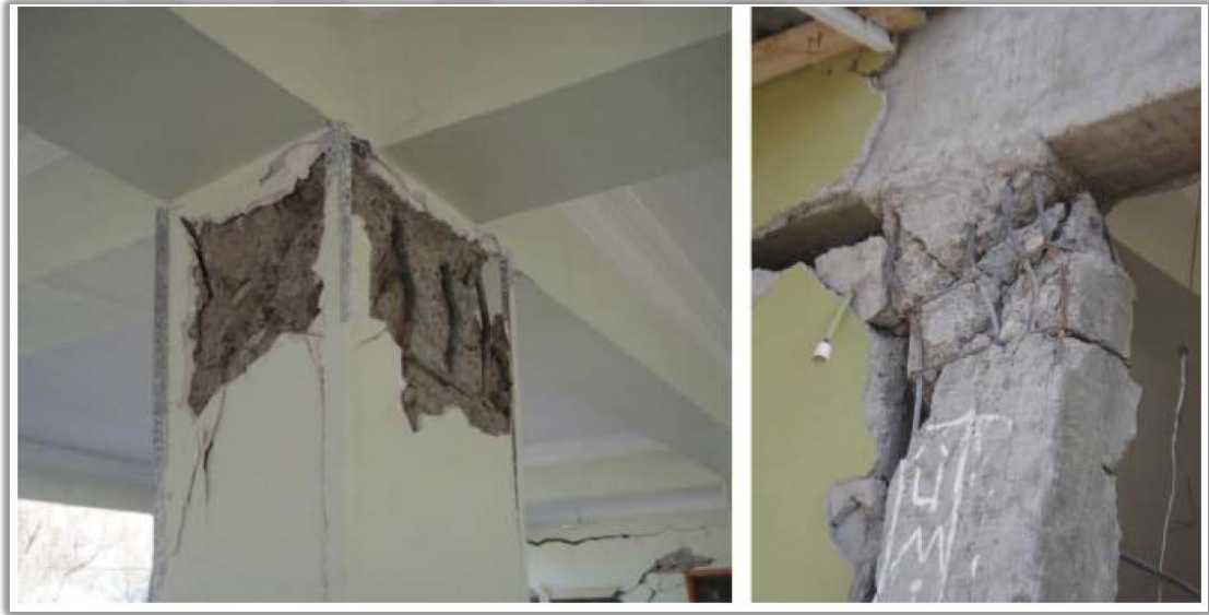
Şekil 4.9. Çok Ağır Hasar almış betonarme elemanlar (D Tipi) [10]
