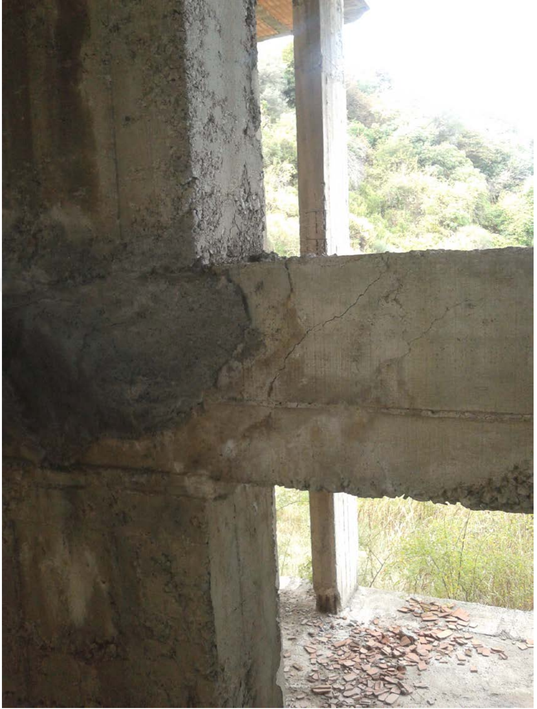
Şekil 6.14. Binada bulunan bir kolon-kiriş bölgesindeki hasar
