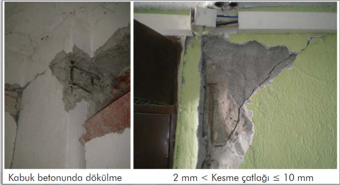
Şekil 4.8. Ağır Hasar almış betonarme elemanlar (C Tipi) [10]
