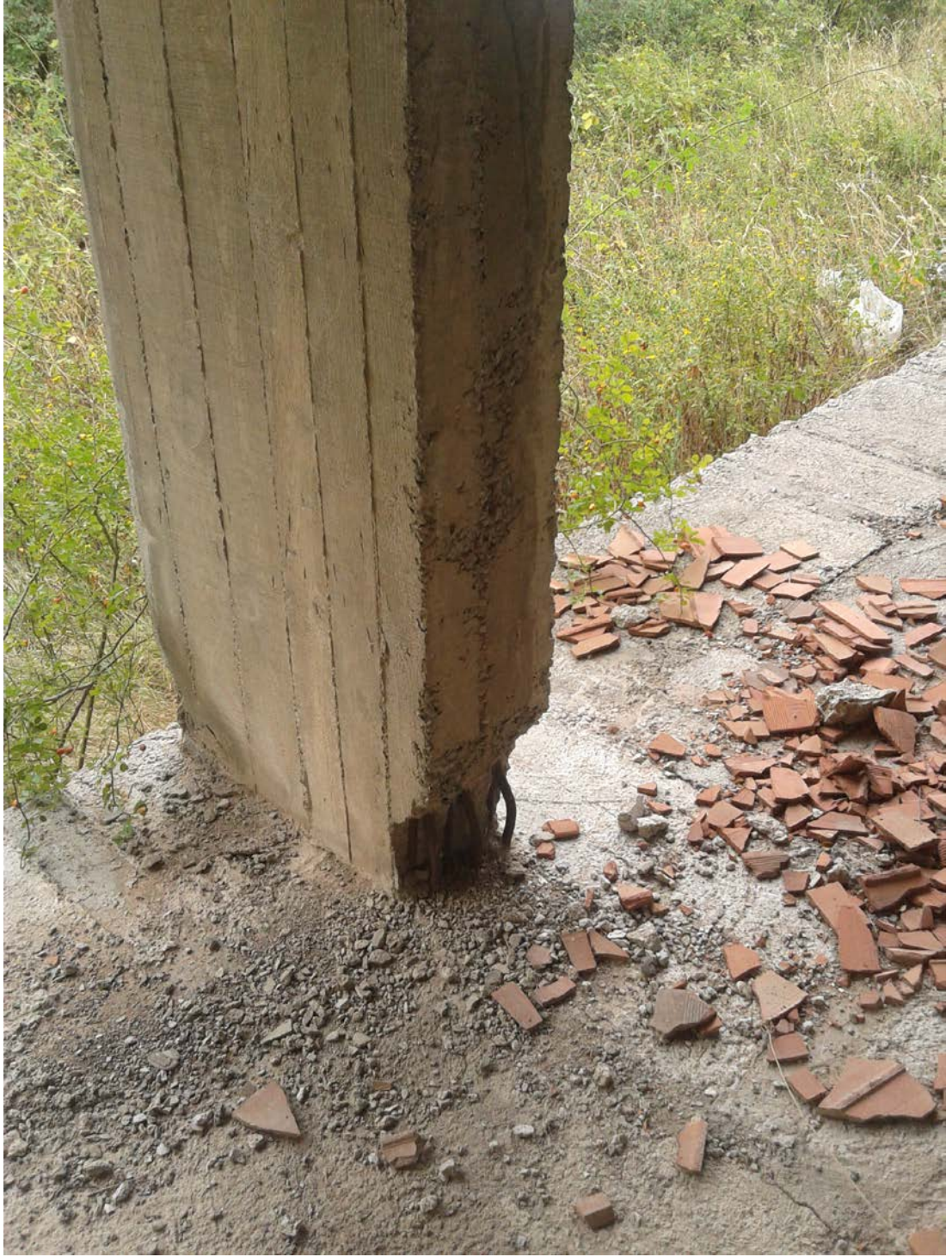
Şekil 6.12. Binanın zemin kat kolonlarında oluşan mafsallaşmalar-1
