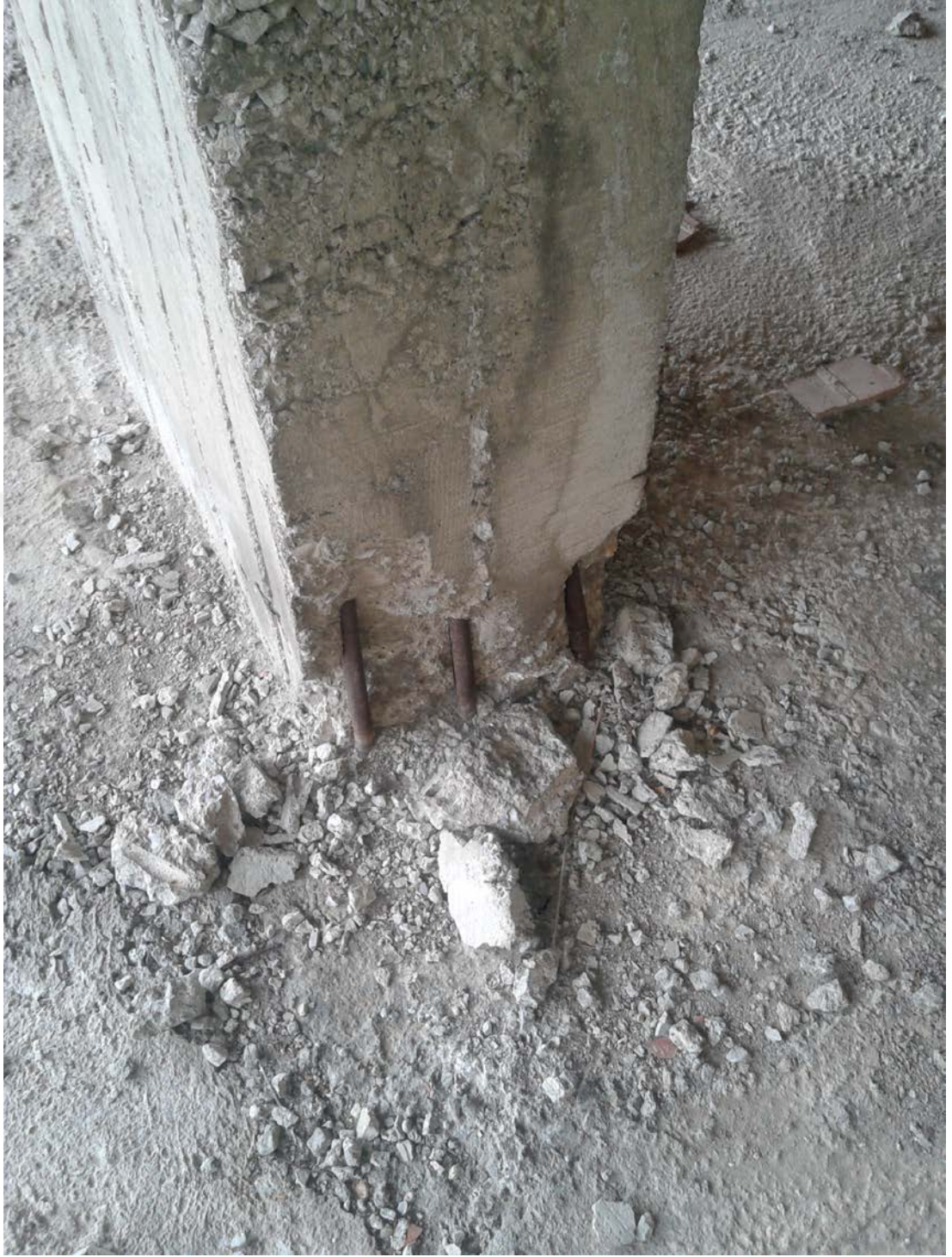
Şekil 6.13. Binanın zemin kat kolonlarında oluşan mafsallaşmalar-2
