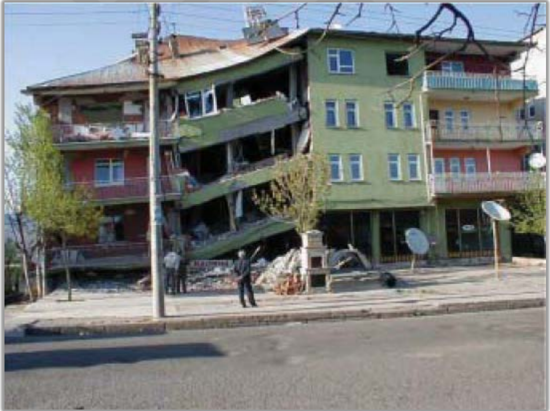
Şekil 4.4. Depremde Bölgesel Göçme Yaşamış Bina [10]
