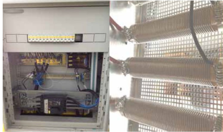
Şekil 5.9. Kademeli yük bankası ve kontrol paneli
