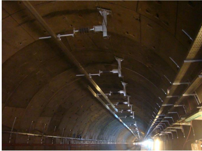
Şekil 2.4. Marmaray hattı 25 kV AC rijit katener sistemi (tünel içi)
