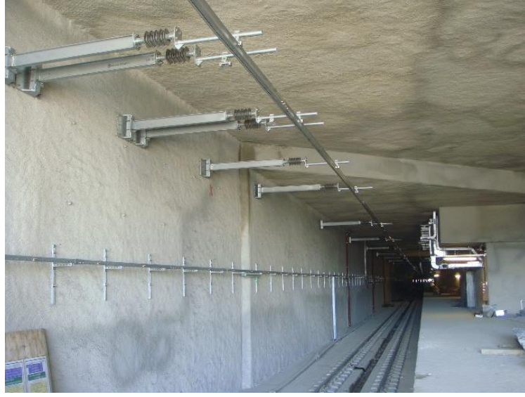
Şekil 2.5. Marmaray 25 kV AC rijit katener sistemi(Ayrılıkçeşmesi-Üsküdar)
