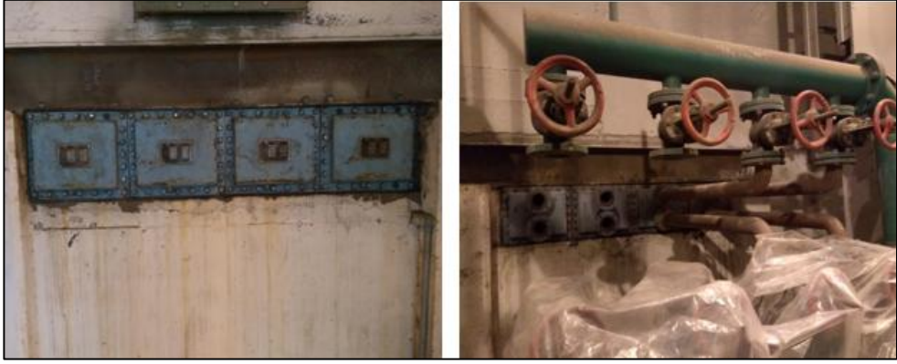
Şekil 3.34. Generatör soğutma sistemi bakımı [21]
