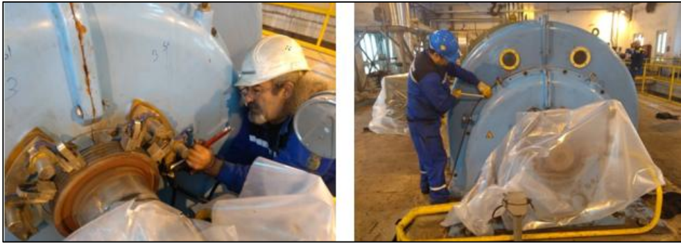
Şekil 3.36. Generatör ikaz sistemi bakımı [21]
