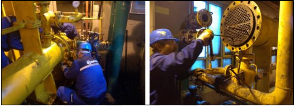
Şekil 3.35. Türbin yağlama sistemi bakımı [21]
