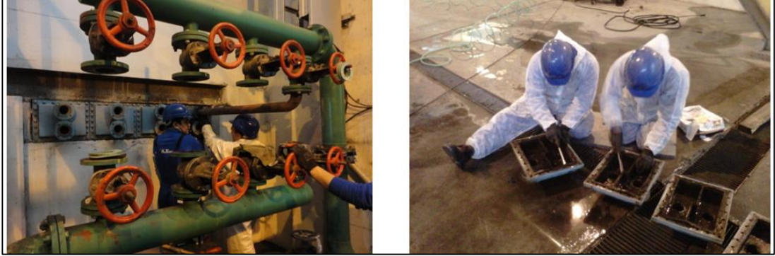
Şekil 3.13. Generatör soğutma sisteminin bakımı [19]
