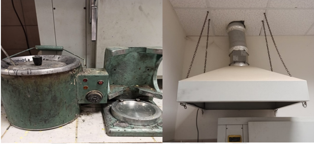
Şekil 3.18. Isıtıcı ve havalandırma
