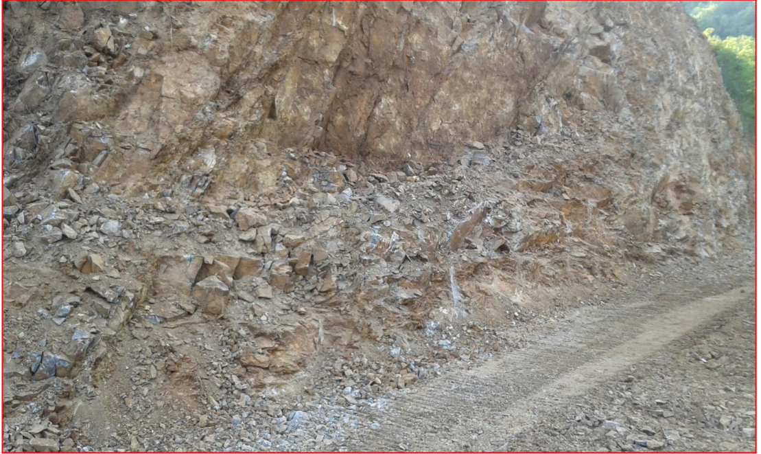
Şekil A.4. Sağ sahilde, memba batardosu hizasında, 550 m kotuna ulaşımı sağlayan yol yarmasında süreksizliklerin akış aşığı eğimli duruşu
