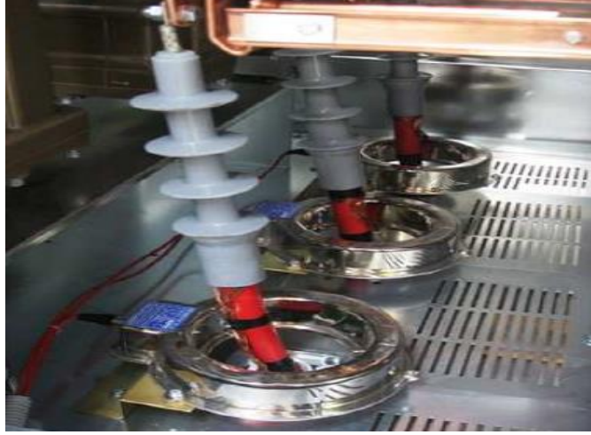
Şekil 3.7. Manyetik olmayan akım transformatörü.
