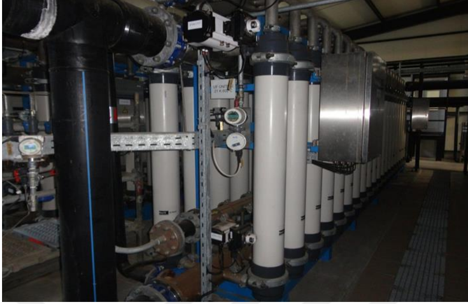
Şekil 2.10. Ultrafiltrasyon ünitesi [Çekim tarihi: 21.07.2015]
