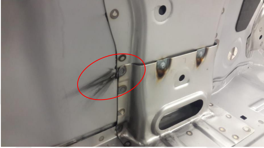
Şekil 4.20. Sacı yapışan çapak örneği
