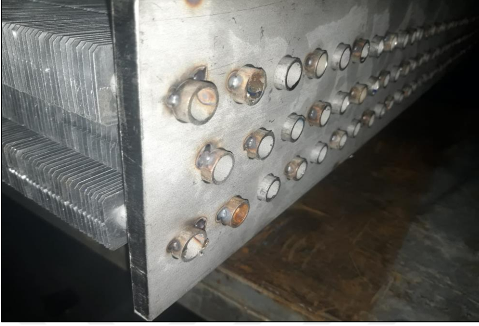
Şekil 4.25. Ön ısıtma bataryası
