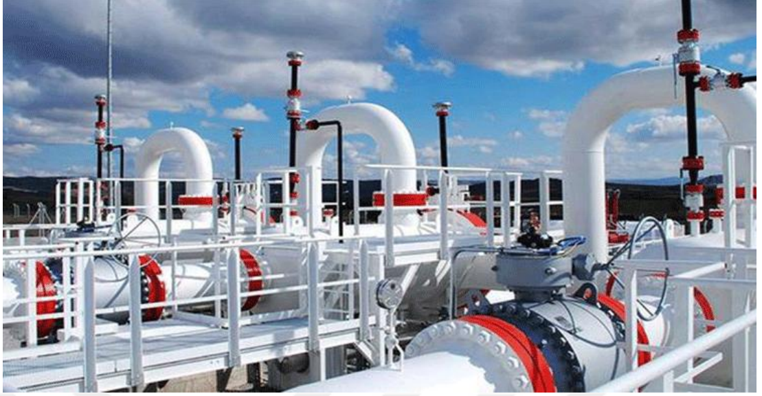
Şekil 1.10. Doğal gaz ölçme ve basınç kontrol istasyonu
