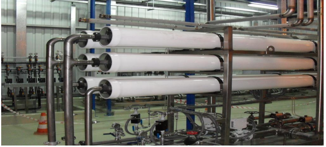
Şekil 1.11. Su arıtma ters ozmoz ünitesi
