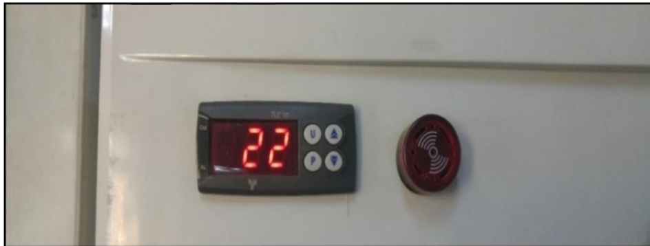
Şekil 2.22. Kabin içerisindeki havanın sıcaklığını gösteren dijital termostat
