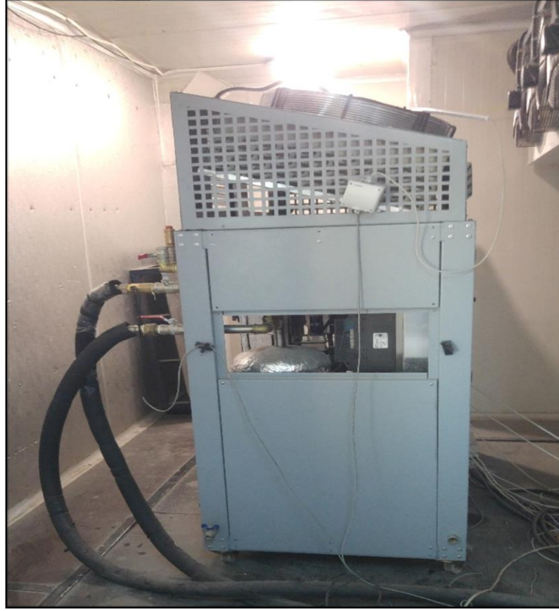
Şekil 2.21. Isı pompası sistemi kabin içerisinde
