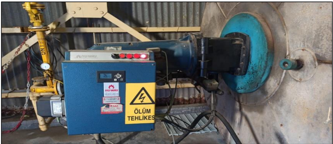
Şekil 8.5. Sıcak yağ kazanı brülörü
