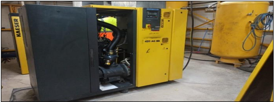
Şekil 7.5. Tesis kompresör dairesi
