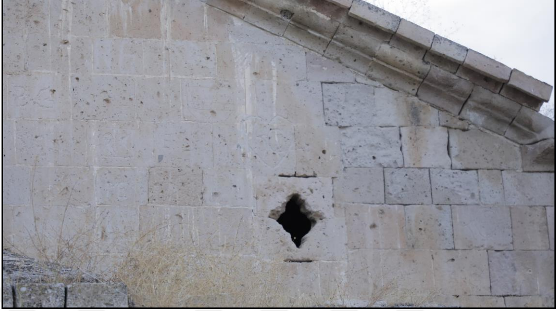
Şekil 4.25. Agios Georgios Kilisesi üst kotlarda bulunan taşlara kazıma işlemi ile verilen tahribat (Songur arşivi, 27.10.2020)
