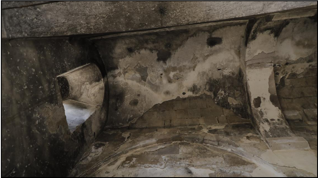
Şekil 4.30. Agios Georgios Kilisesi tonoz yüzeyinde gözlenen rutubet, nem ve sıva dökülmeleri (Songur arşivi, 27.10.2020)
