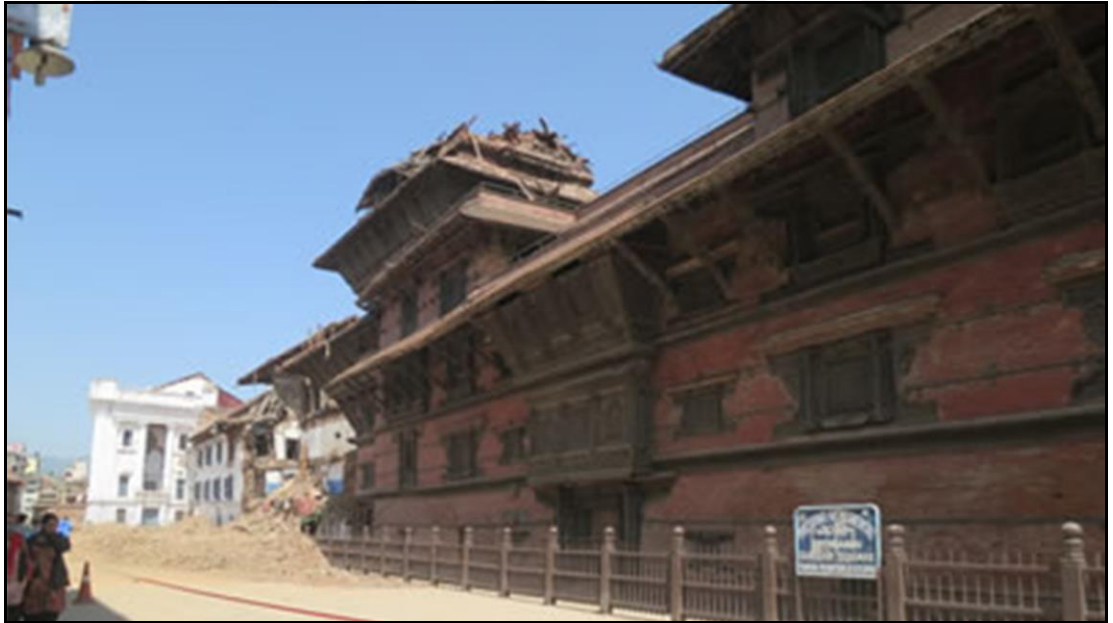
Şekil 2.13. Hanuman Dhoka'da saray ve tapınak binasındaki hasar durumu (Vatan, 2015)
