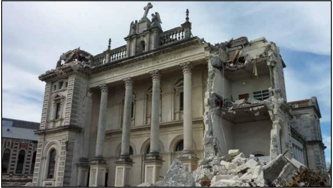
Şekil 2.8. Yeni Zelanda'daki Christchurch Katedrali'nde meydana gelen deprem hasarı (UNISDR ve diğ., 2013)
