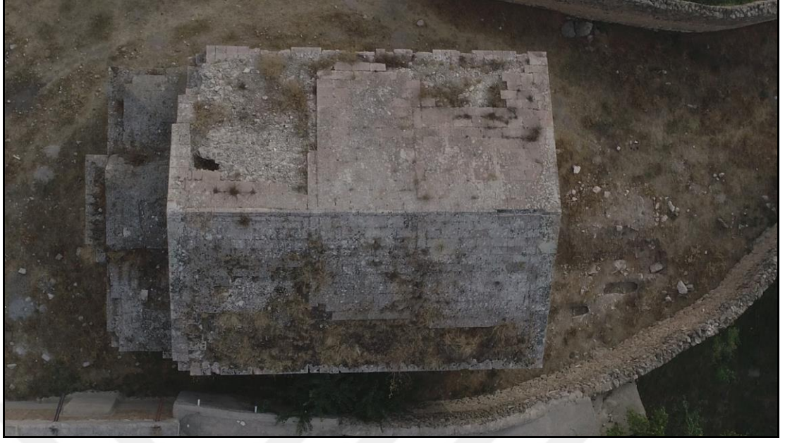
Şekil 4.27. Agios Georgios Kilisesi çatısında görülen vandalizm (Songur arşivi, 27.10.2020)
