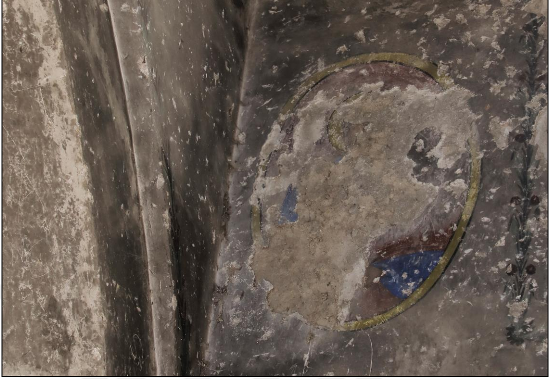
Şekil 4.19. Agios Georgios Kilisesi'ne uygulanan vandalizm sonucunda bütünlüğü büyük ölçüde bozulmuş bir duvar resmi (Songur arşivi, 27.10.2020)
