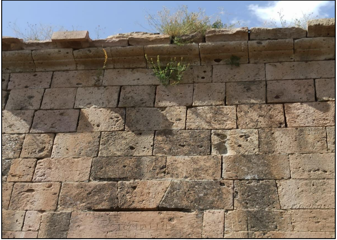
Şekil 4.32. Agios Georgios Kilisesi yapı taşlarındaki dış cephede meydana gelen bozulmalar (Songur arşivi, 02.07.2021)
