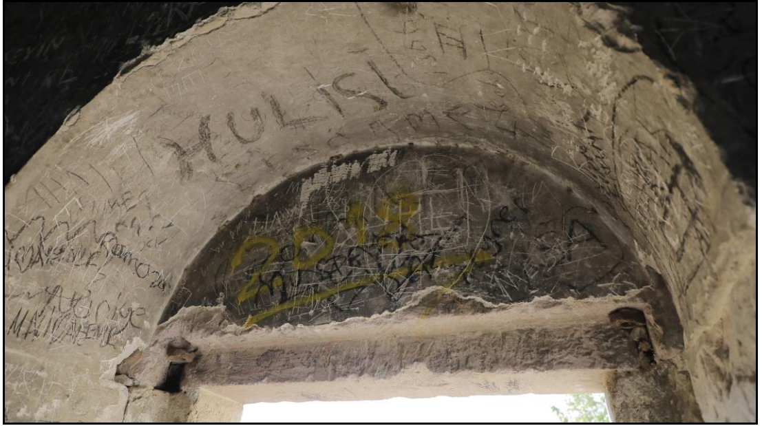
Şekil 4.24. Agios Georgios Kilisesi kapı boşluğunda bulunan vandalizm etkisindeki yazılar (Songur arşivi, 27.10.2020)
