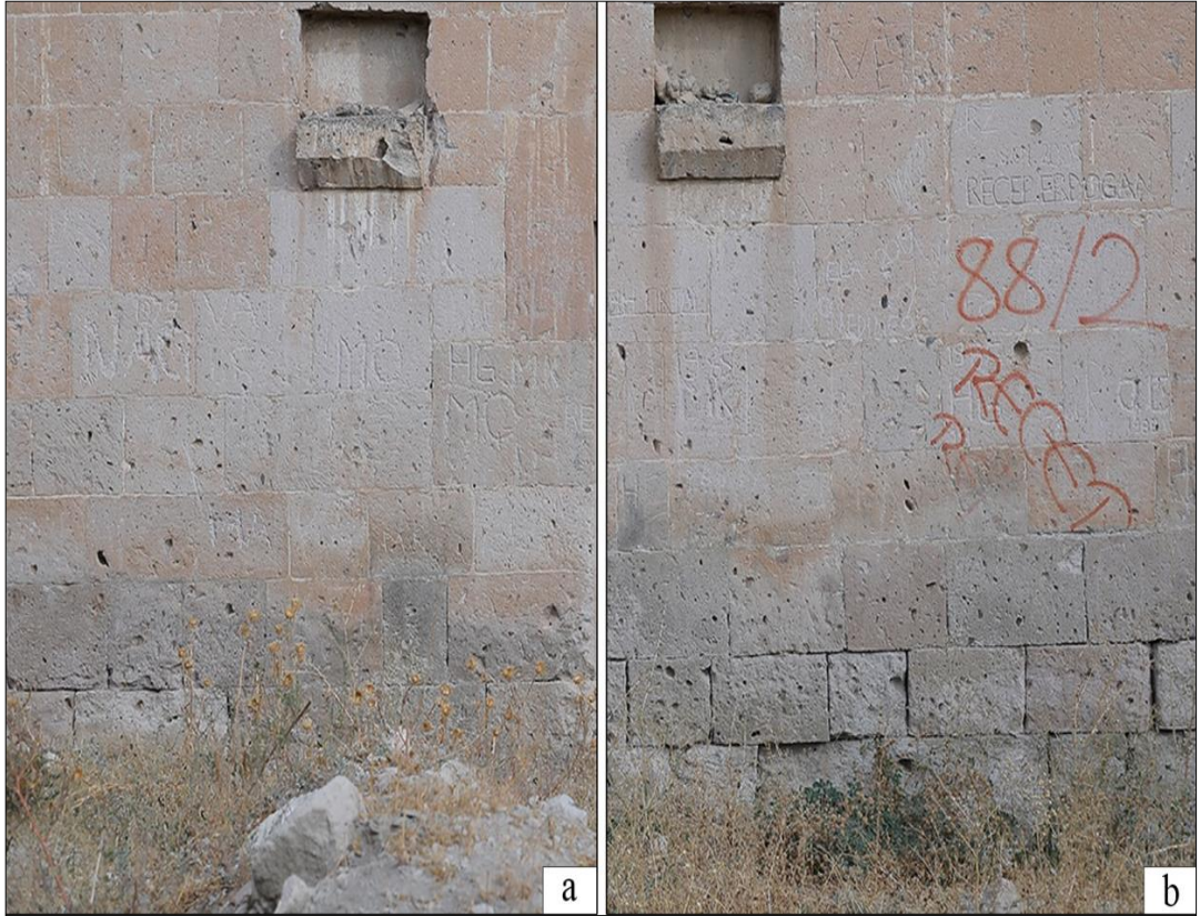
Şekil 4.22. a) Agios Georgios Kilisesi kapı boşluğunun kuzey tarafında yer alan vandalizm izleri, b) Agios Georgios Kilisesi kapı boşluğunun güney tarafında yer alan vandalizm izleri (Songur arşivi, 27.10.2020)
