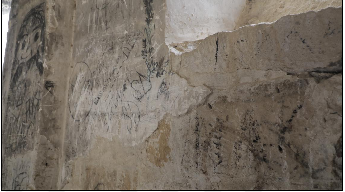
Şekil 4.23. Agios Georgios Kilisesi duvarlarına yapılan vandalizm etkisindeki çizimler ve yazılar (Songur arşivi, 27.10.2020)
