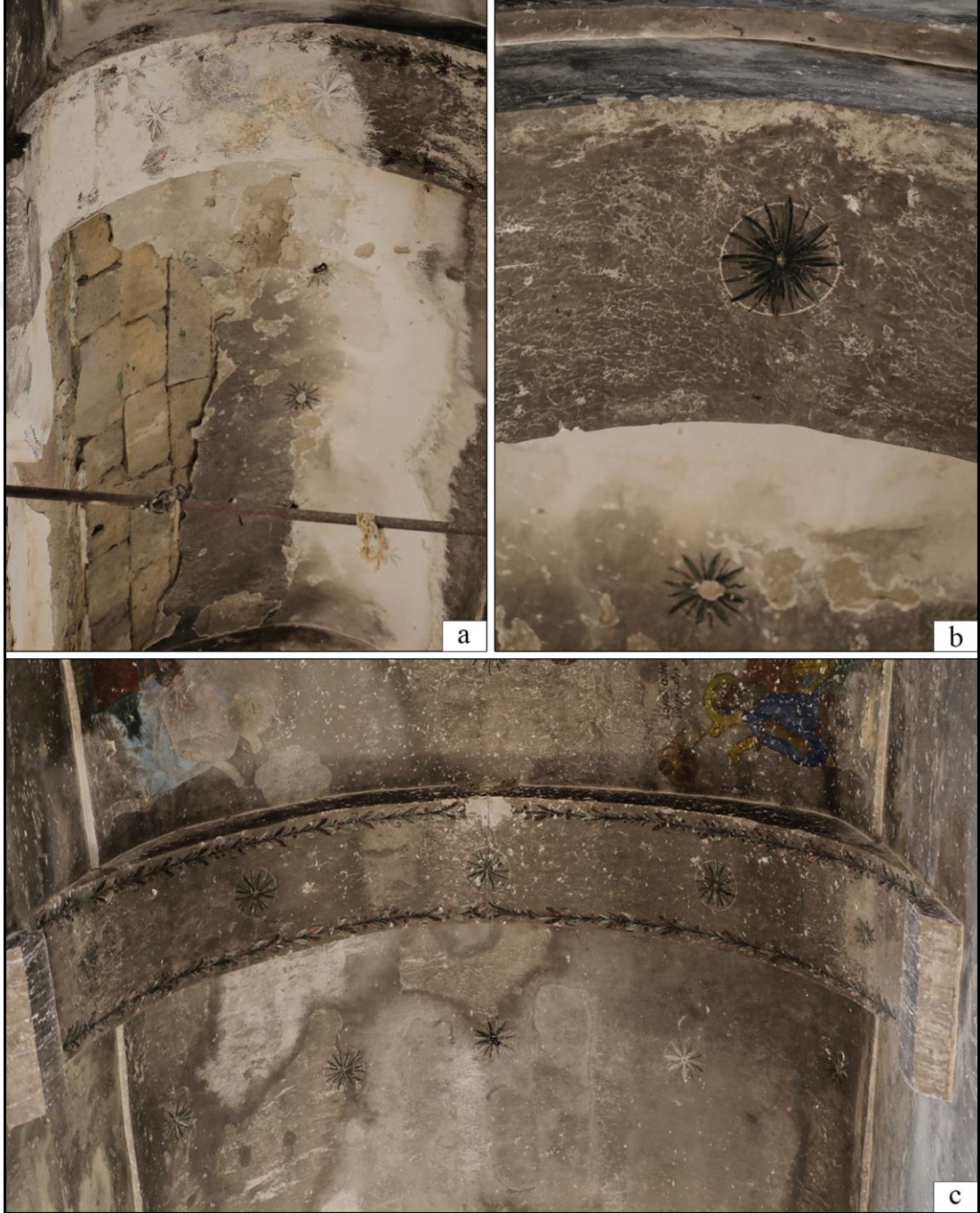
Şekil 3.20. a) tonoz örtü, b) tavadaki yıldız figürü detayı, c) tonoz kenarlarındaki süslemeler (Songur arşivi, 27.10.2020)
