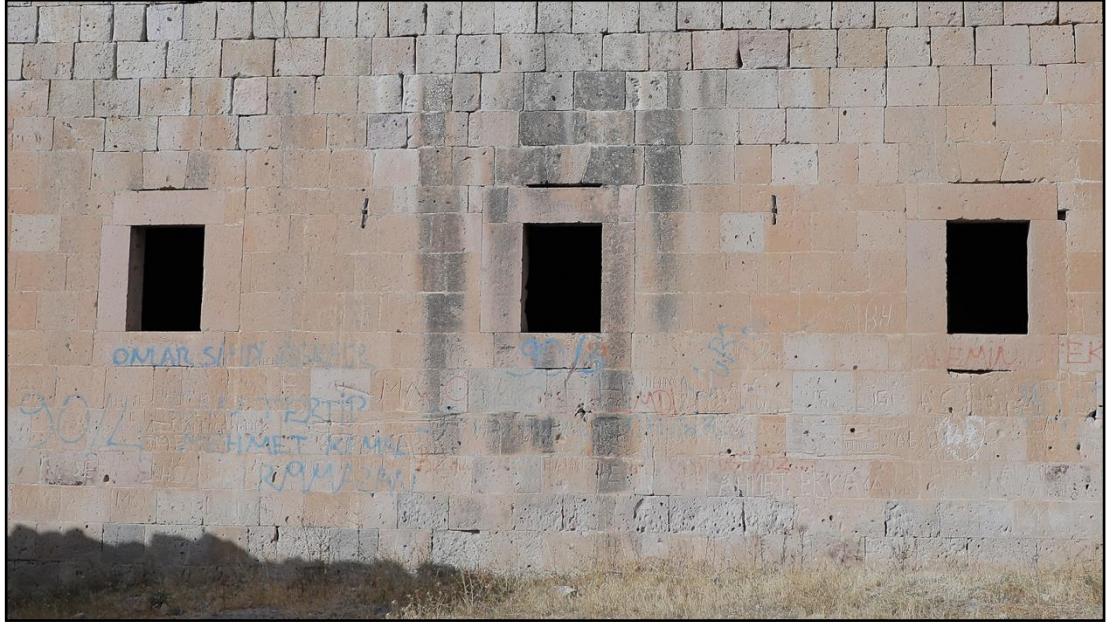
Şekil 4.26. Agios Georgios Kilisesi doğu cephesinde yer alan vandalizm izleri (Songur arşivi, 27.10.2020)
