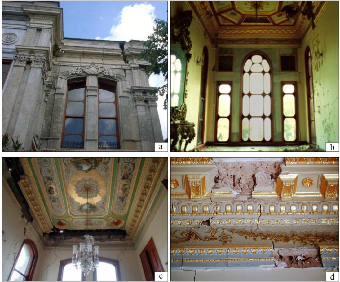
Şekil 2.5. a) parapet duvarlarında oluşan derin çatlaklar, b) yapının deprem sonrası durumu, c) tavanlarda oluşan ciddi hasarlar, d) duvar-tavan birleşimindeki pervaz işlemlerinde görülen hasarlar (Kahya, 2012)
