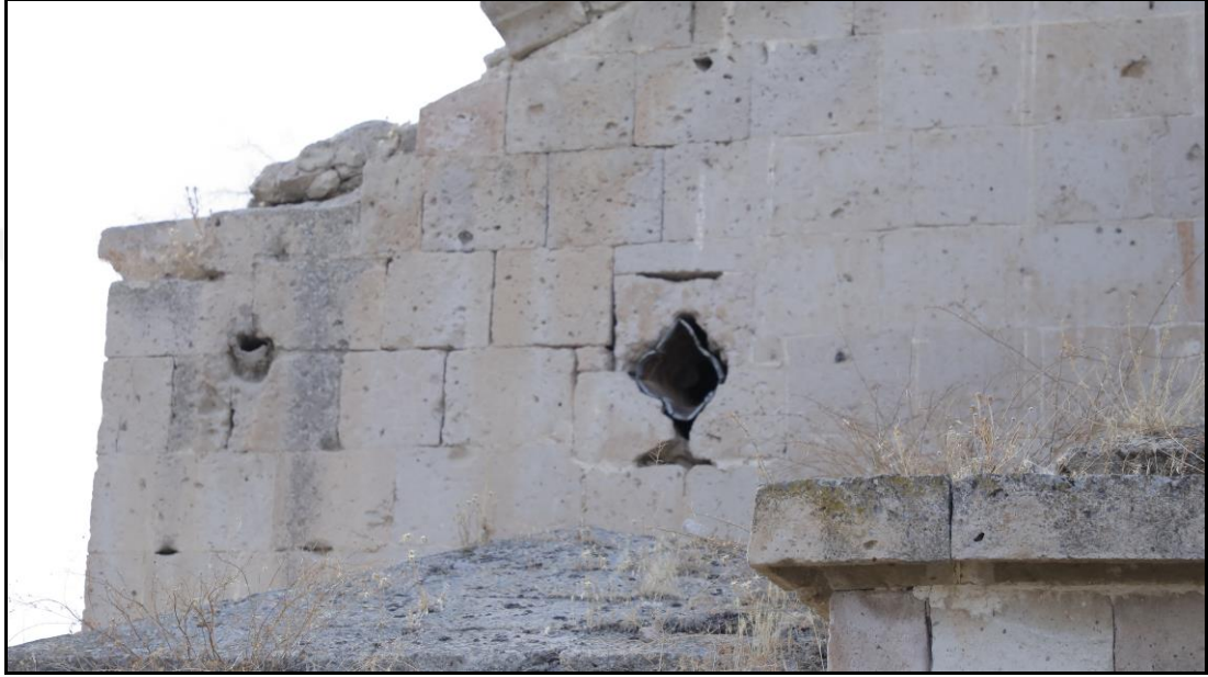
Şekil 4.34. Agios Georgios Kilisesi güney cephesi çatı alınlığında meydana gelen malzeme kaybı detayı (Songur arşivi, 27.10.2020)
