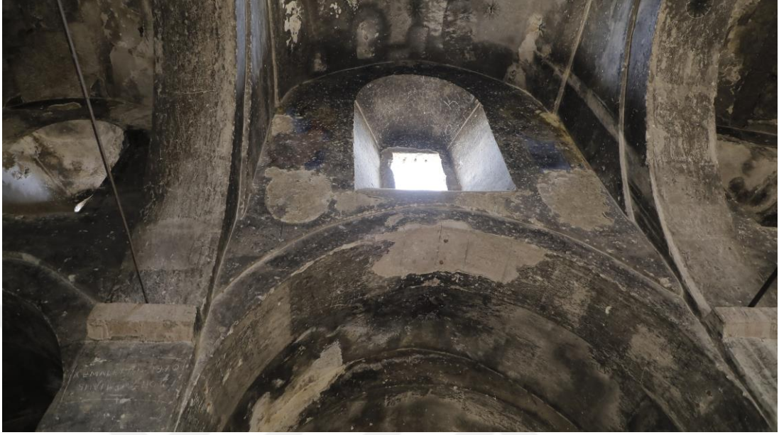
Şekil 4.29. Agios Georgios Kilisesi genelinde gözlenen rutubet, nem ve sıva dökülmeleri (Songur arşivi, 27.10.2020)
