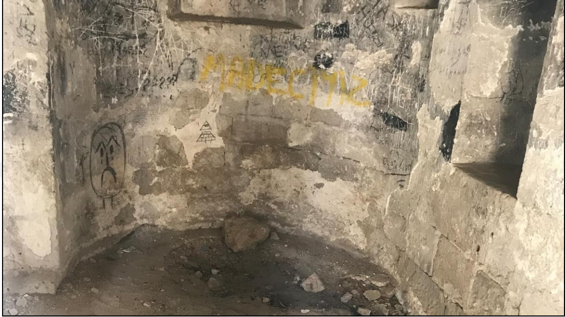
Şekil 4.12. Agios Georgios Kilisesi duvarlarına grafiti ile verilen tahribat ve sıva kayıplarının durumu (Songur arşivi, 27.10.2020)
