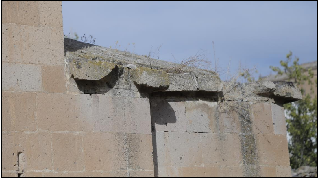
Şekil 4.33. Agios Georgios Kilisesi doğu apsidol üst örtü silmesinde meydana gelen malzeme kaybı detayı (Songur arşivi, 27.10.2020)
