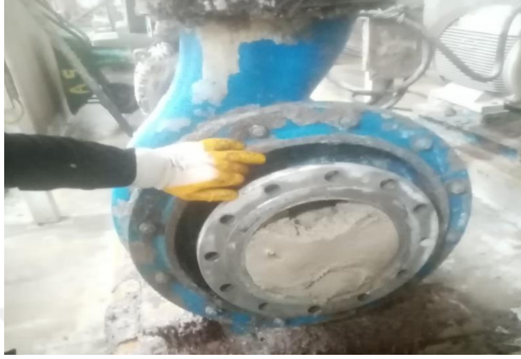
Şekil 7.5. Pompa emiş ağızı tıkanıklığı
