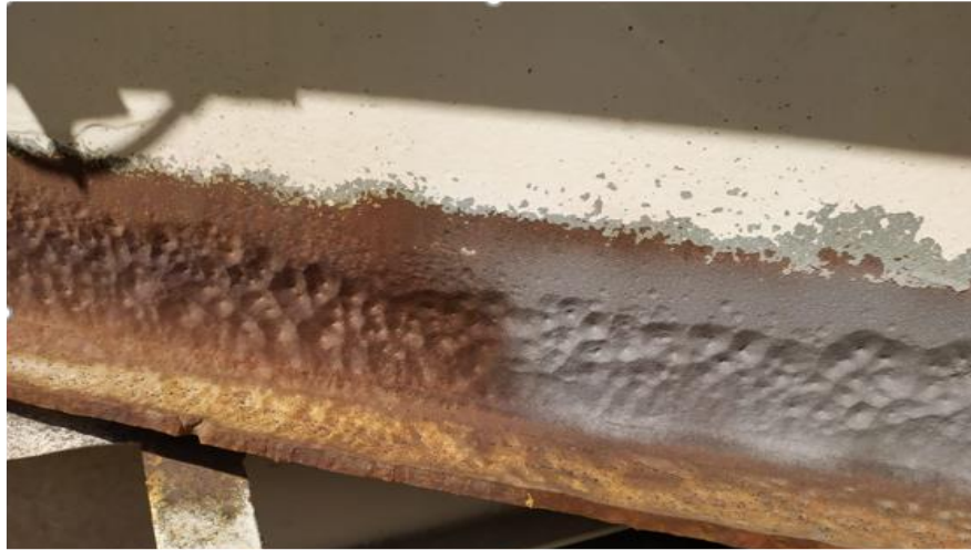
Şekil 6.3. Çukurcuk (pitting) korozyonu
