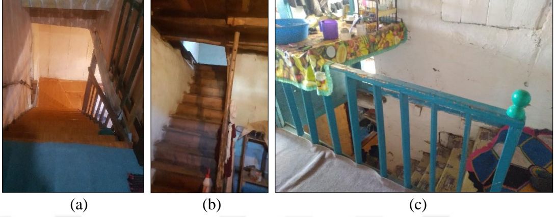
Şekil 4.87. Tek kollu ve L biçiminde merdiven (a), Korkuluk bulunmayan düz biçimde merdiven (b), Ahşap kapakla kısmen kapatılmış merdiven üstü (c) – Merkez Mahallesi (Gümüş Yıldırım, 2019)
