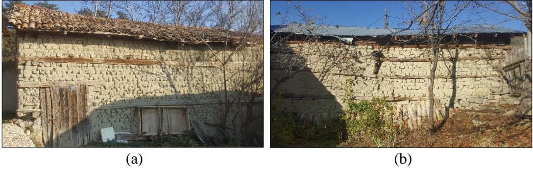
Şekil 4.80. Kerpiç yığma sistem ile inşa edilmiş samanlık yapıları – Merkez Mahallesi (a), Hapşanlar Mahallesi (b) (Gümüş Yıldırım, 2019)
