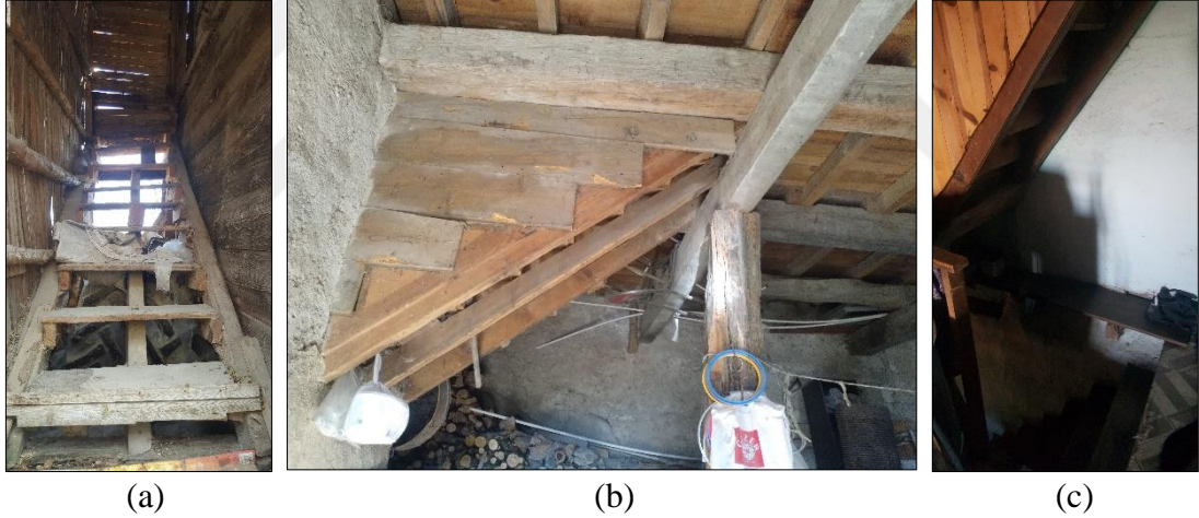
Şekil 4.88. Limon kiriş sistemi – Merkez Mahallesi (a), Şabanlar Mahallesi (b), Hapşanlar Mahallesi (c) (Gümüş Yıldırım, 2019)
