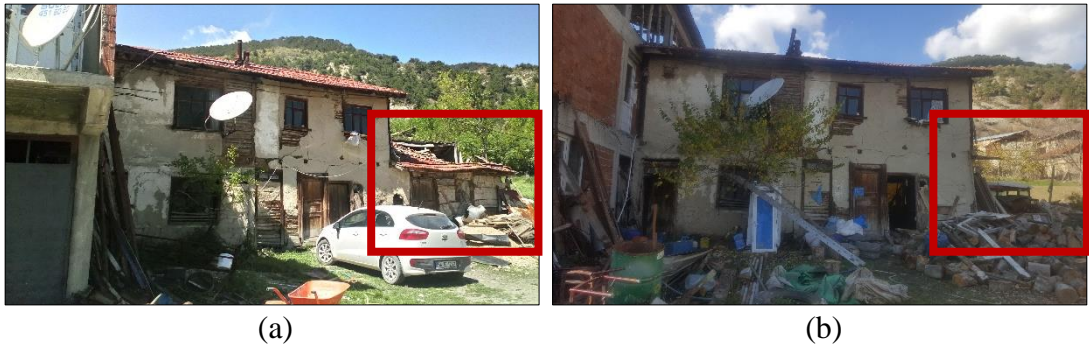
Şekil 4.54. 2019 yılında yıkılan ahır yapısı – Merkez Mahallesi (a – Gümüş Yıldırım, 2018, b – Gümüş Yıldırım, 2019)
