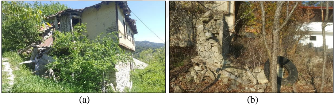
Şekil 4.14. Sağlamlık durumu kötü derecede olan yapı – Merkez Mahallesi (a), Yıkılmış durumda olan yapı – Şabanlar Mahallesi (b) (Gümüş Yıldırım, 2019)
