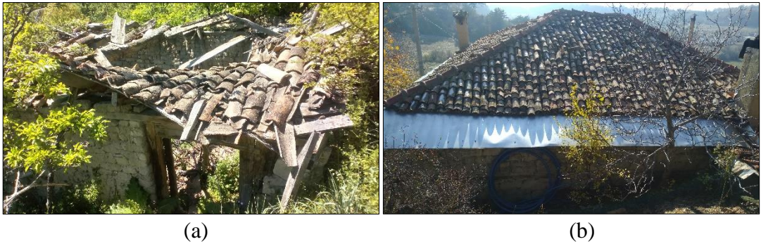
Şekil 6.16. Çatıda meydana gelen bozulmalar (a), Özgün olmayan malzeme ile çatı onarımı (b) – Şabanlar Mahallesi (Gümüş Yıldırım, 2019)
