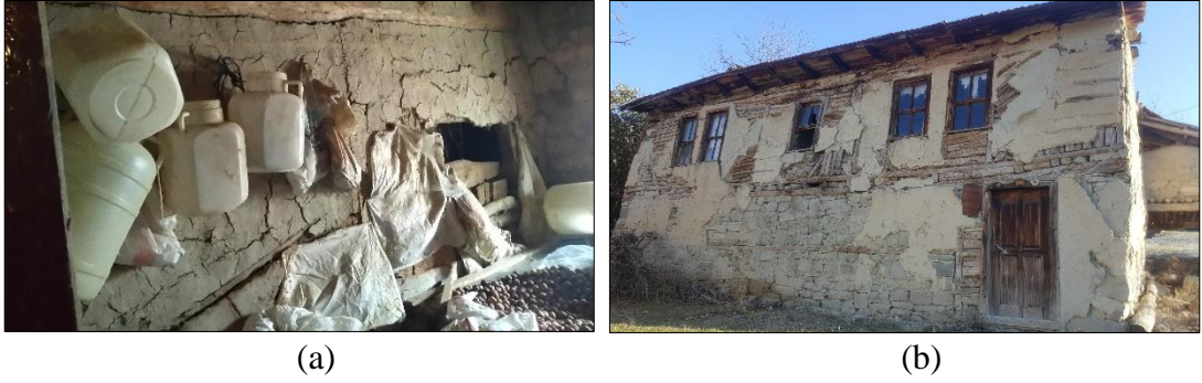
Şekil 6.20. Sıvada meydana gelen bozulmalar – Merkez Mahallesi (a), Hapşanlar Mahallesi (b) (Gümüş Yıldırım, 2019)
