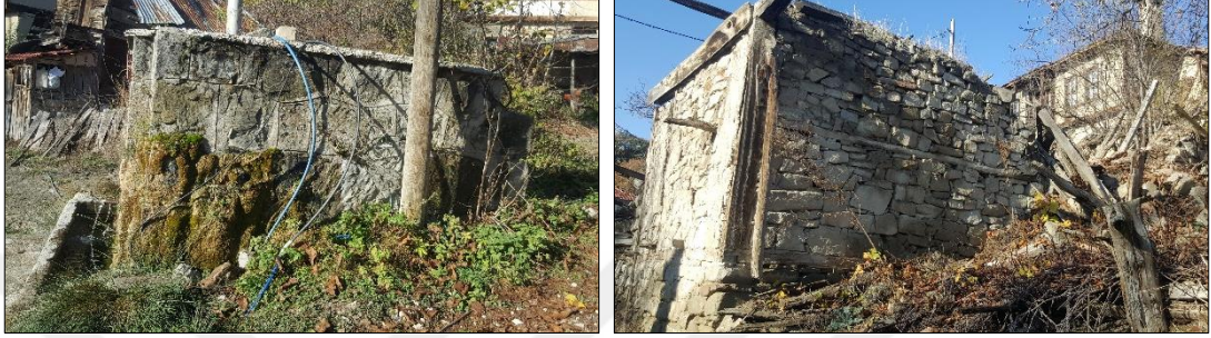
Şekil 6.17. Taş malzemede meydana gelen bozulmalar – Merkez Mahallesi (Gümüş Yıldırım, 2019)
