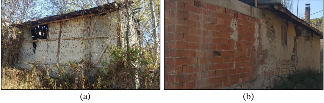
Şekil 6.13. Kısmen yıkılmış duvar (a), Ek mekân yapımında duvara aşırı yük binmesi (b) – Merkez Mahallesi (Gümüş Yıldırım, 2019)
