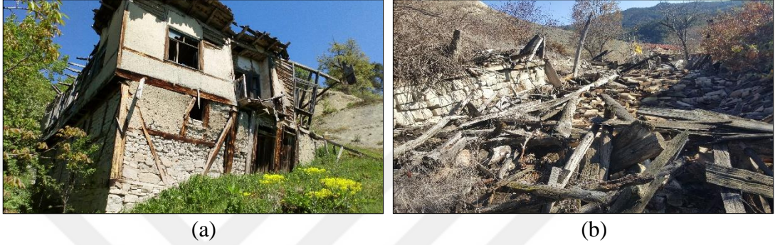
Şekil 6.8. Kismen yıkılmış konut yapısı (a), Yıkılmış saya yapısı (b) – Merkez Mahallesi (Gümüş Yıldırım, 2019)
