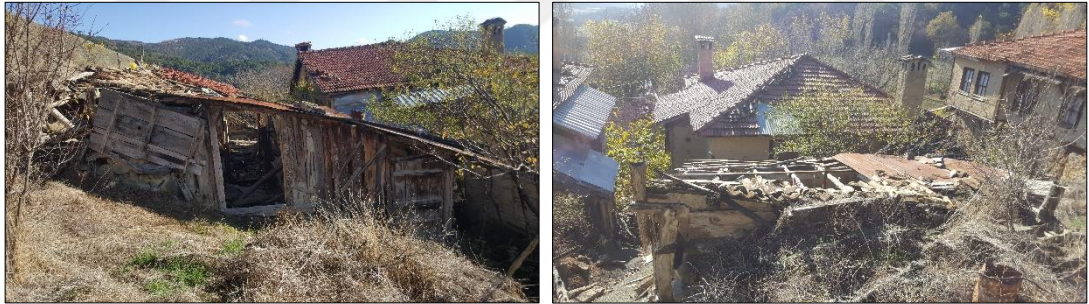
Şekil 4.56. Kısmen yıkılmış saya yapısı – Merkez Mahallesi (Gümüş Yıldırım, 2019)
