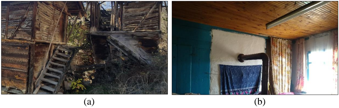
Şekil 6.14. Ahşap merdivenlerde meydana gelen bozulmalar (a), Özgün olmayan tavan kaplaması (b) – Merkez Mahallesi (Gümüş Yıldırım, 2019)
