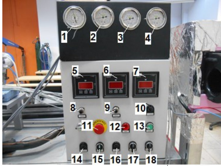
(1: Düşük basınç manometresi, 2: Yüksek basınç manometresi, 3: İç ünite genişleme valfi giriş basıncı, 4: İç ünite genişleme valfi çıkış basıncı, 5: Dış ünite ısıtıcı gücü, 6: İç ünite ısıtıcı gücü, 7: Elektrik motoru elektriksel gücü, 8: Dış ünite ısı yük ayarı, 9: İç ünite ısı yük ayarı, 10: İnverter frekans ayarı, 11: Acil stop, 12: Arıza lambası, 13: Çalıştırma lambalı butonu, 14: Dış ünite fan hız ayarı, 15: Sistem açma seçici anahtarı, 16: İç ünite fanları hız ayarı, 17: Kompresör seçim anahtarı, 18: Isı pompası / klima seçim anahtarı)
