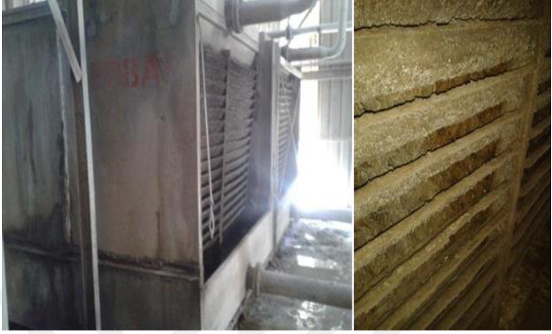
Şekil 4.15. 1 ve 2 Teknolojik havuz soğutma kuleleri (solda) ve tıkalı dolgu malzemeleri (sağda)
