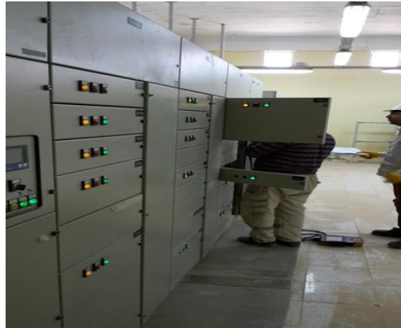
Şekil 6.3. 0,4 kV MCC panolarının görünüm
