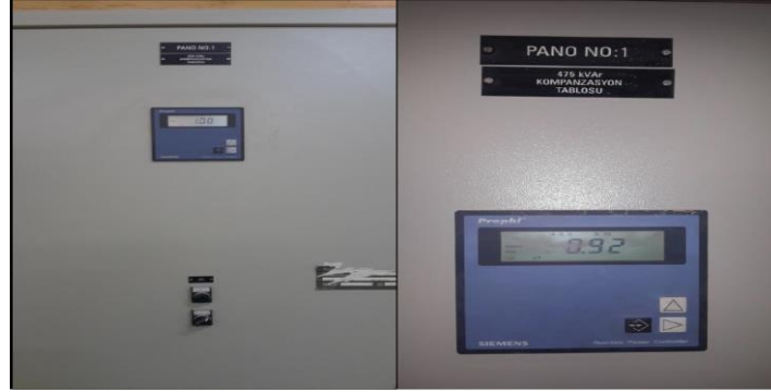
Şekil 6.4. 0,4 kV kompanzasyon panolarının görünüm
