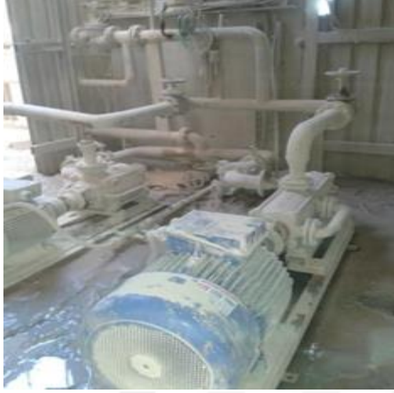
Şekil 4.12. Fırın 2 soğutma kulesi pompaları
