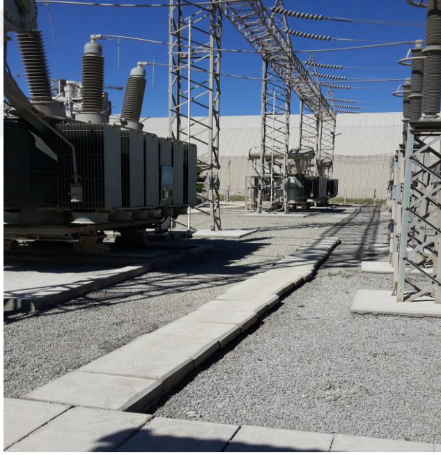
Şekil 6. 1. 25-30-30 MVA 154/6,3 kV trafo TM
