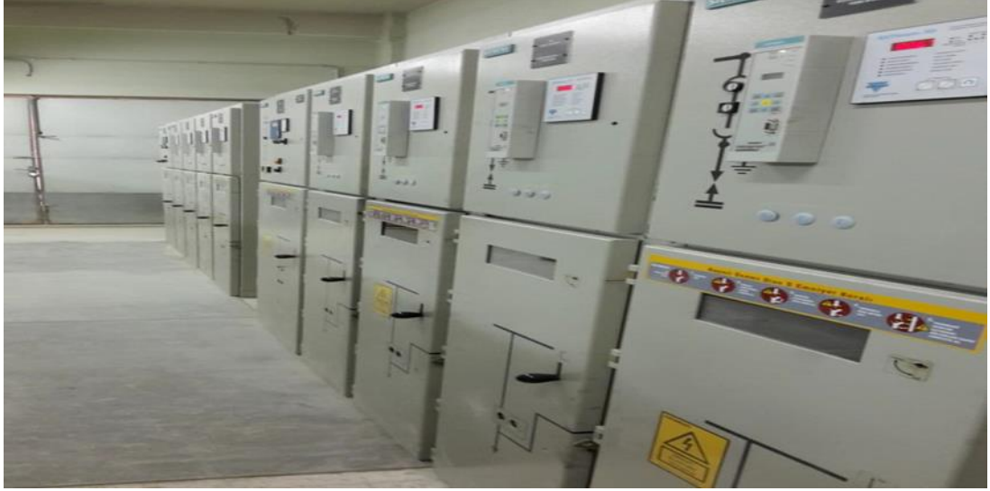
Şekil 6.2. 6,3 kV O.G dağıtım hücreleri görünümü (OG ana dağıtım, B ve C baraları)
