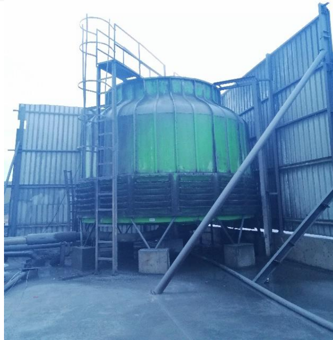
Şekil 4.10. Soğutma kulesi genel görünüşü
