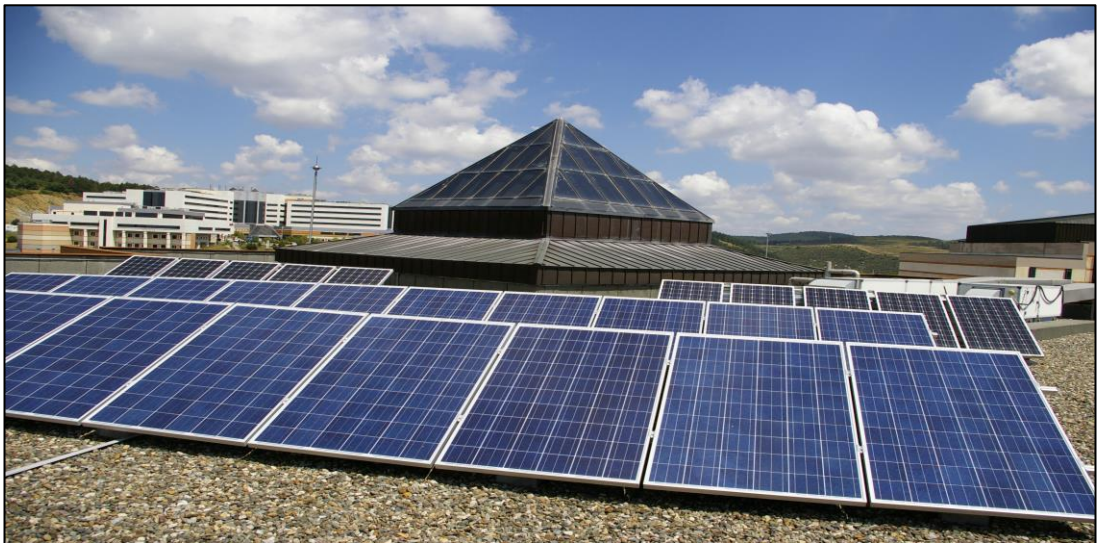
Şekil 4.25. Teknoloji fakültesi binasının çatısında 5,1 kWp'lik polikristal güneş modülleri
