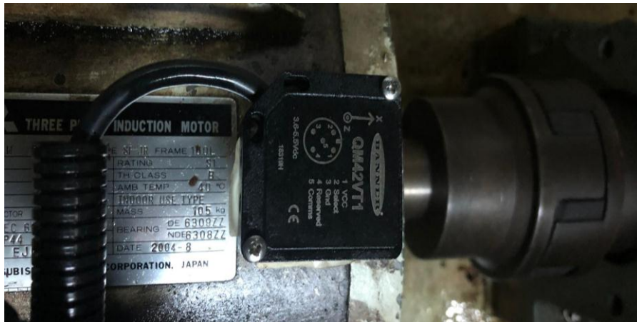
Şekil 3.3. Çalışma yapılan sensörlerin montajı
